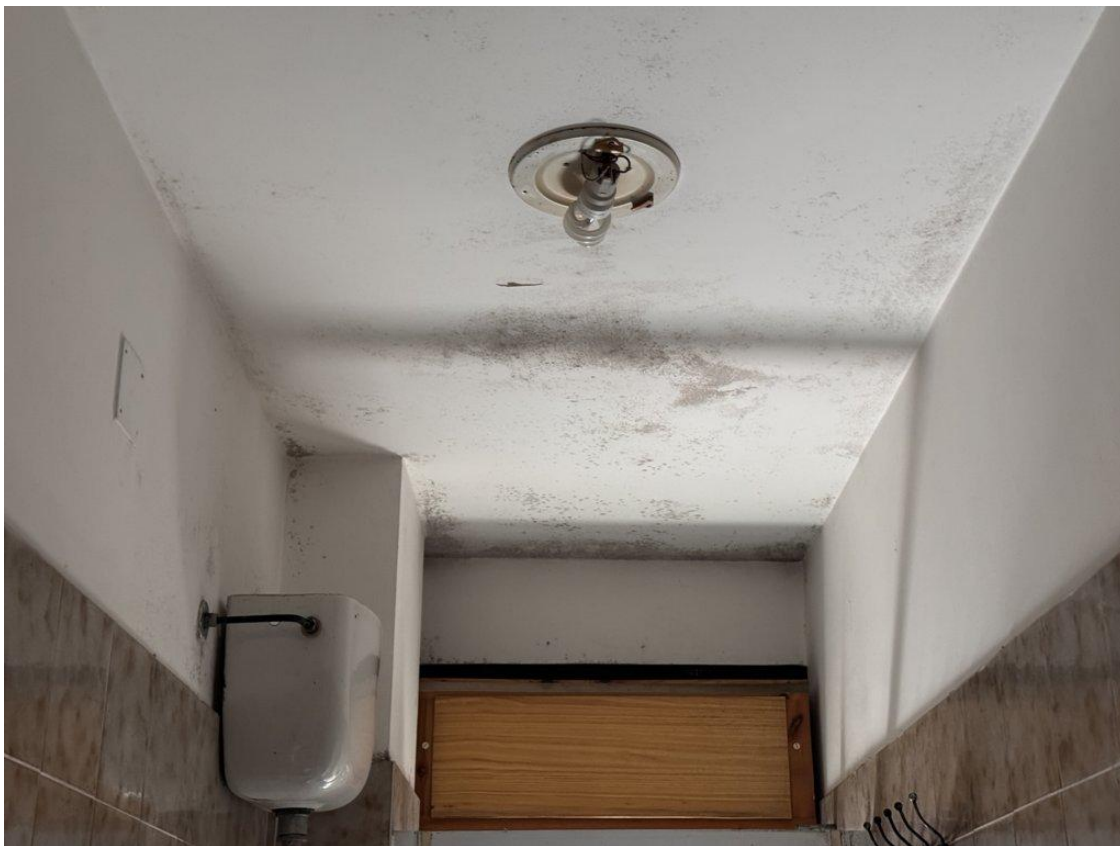
17. Vista della presenza di macchie di umidità sul soffitto del w.c.
