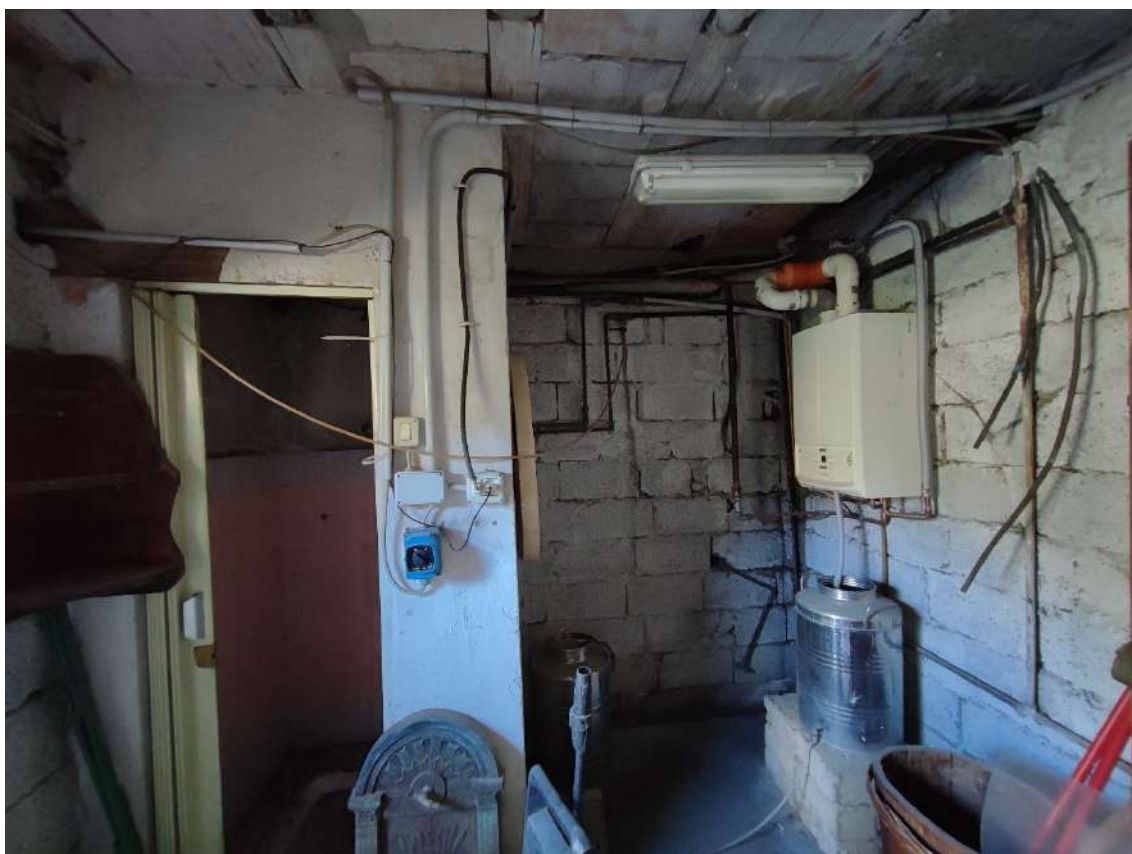
FOTO 20: Vano caldaia a piano seminterrato
