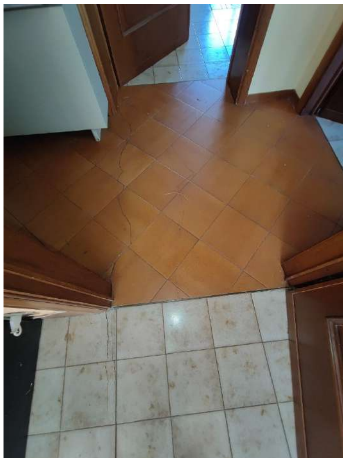
FOTO 16: lesione pavimento camere/disimpegno
