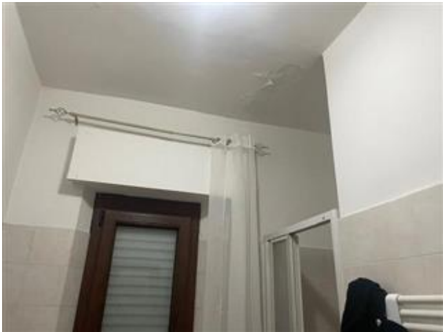
macchie su soffitto bagno
