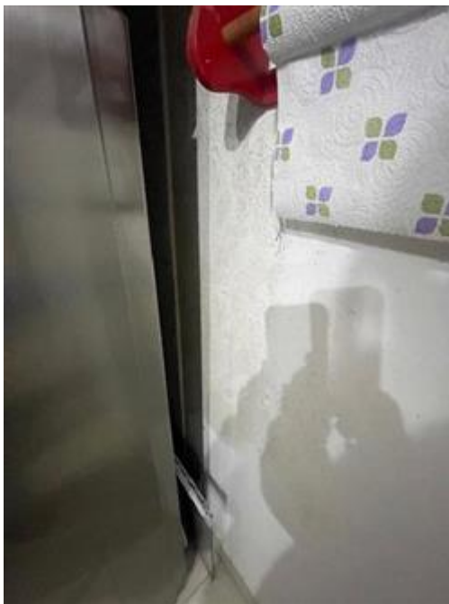
macchia di umidità in cucina
