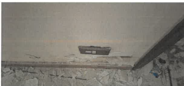
Fotografia 52 – fenomeni infiltrativi da bagno a ripostiglio a piano primo
