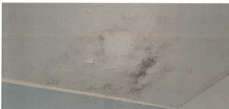
Fotografia 40 – fenomeni infiltrativi nella camera matrimoniale a piano primo da copertura
