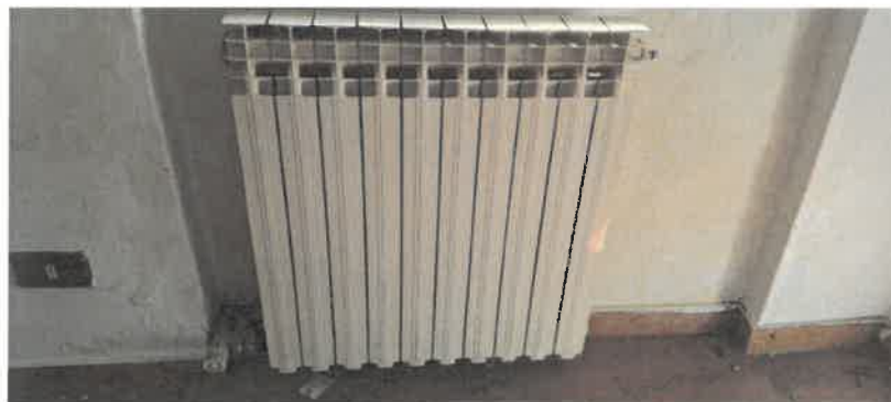
Fotografie 10 e 11 – dotazioni impiantistiche camera matrimoniale a Piano Primo
