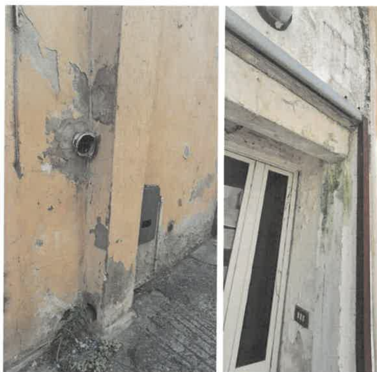
Fotografie 38 e 39 – stato di conservazione intonaci esterni
