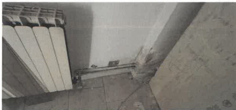
Fotografia 65 – fenomeni infiltrativi a piano terra
