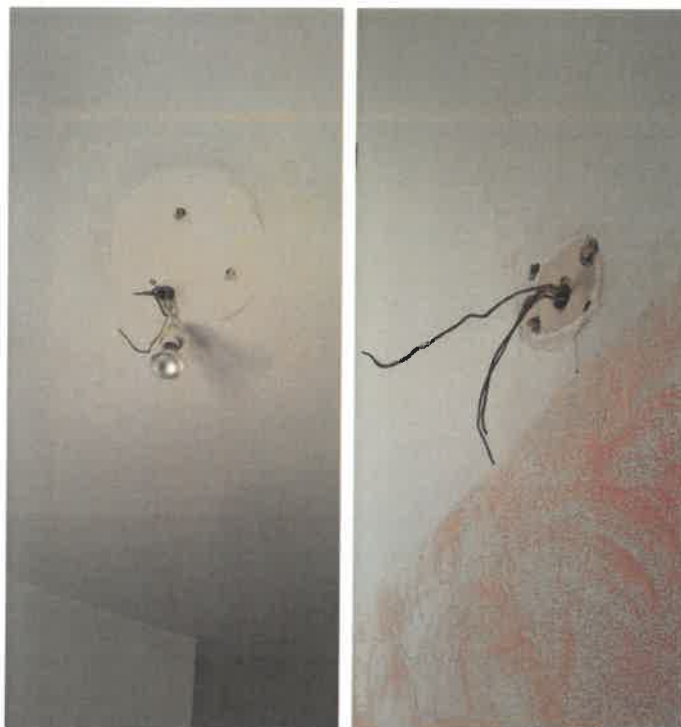
Fotografie 48 e 49 – intonaci interni che richiedono ripristini
