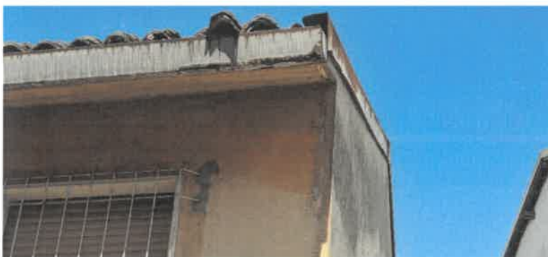
Fotografie 66, 67 e 68 – stato di conservazione gronda in getto di calcestruzzo (fessurata) e lattonerie esterne (ossidate) (canna fumaria sul fronte ovest dismessa successivamente al rilievo fotografico)
