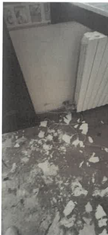
Fotografia 21 – porzione di impianto elettrico – ripostiglio a piano primo
