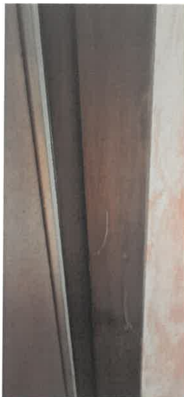
Fotografia 47 – porte da interni che richiedono ripristini
