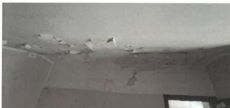
Fotografie 41 e 42 – fenomeni infiltrativi nel bagno e ripostiglio a piano primo da copertura
