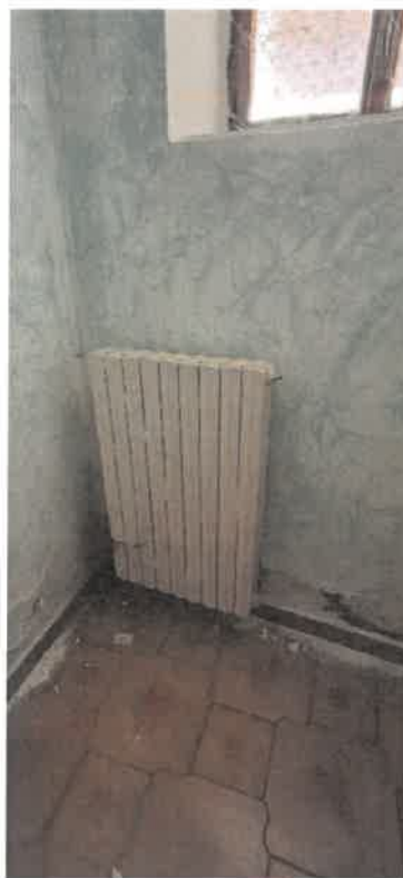
Fotografia 33 – climatizzazione invernale del ripostiglio a piano terra in violazione della Legge Regionale 11 dicembre 2006, N. 24 (necessita di chiusura della parte di impianto)
