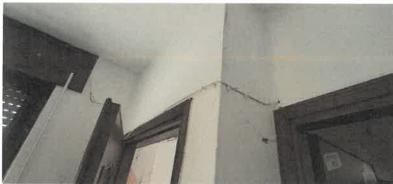
Fotografia 14 – impiantistica disimpegno a piano primo
