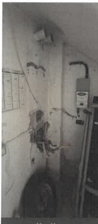
Fotografia 80 – contatore energia elettrica nel sottoscala / generatore di calore mancante
