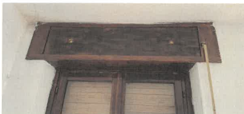
Fotografia 44 – ponti termici nella camera matrimoniale a piano primo
