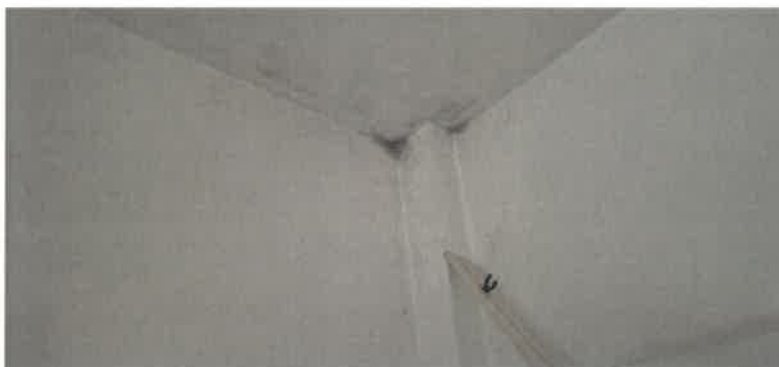
Fotografia 64 – ponti termici a piano terra
