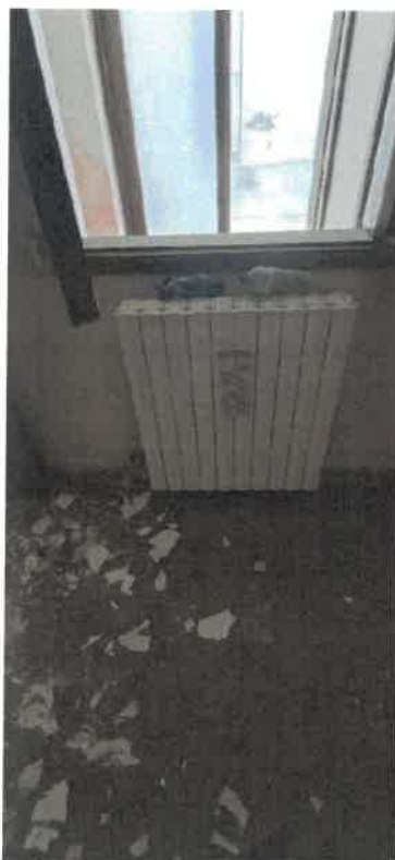
Fotografia 20 – climatizzazione invernale del ripostiglio a piano primo in violazione della Legge Regionale 11 dicembre 2006, N. 24
