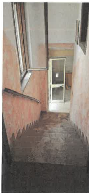
Fotografia 22 – scala di collegamento tra piano primo e terra – mancorrente che richiede ripristini
