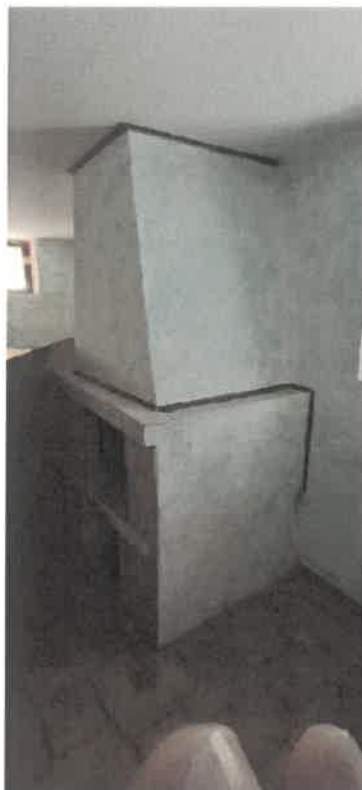
Fotografia 32 – caminetto non chiuso, non certificato, non conforme alle Norme e in violazione della Legge Regionale 11 dicembre 2006, N. 24 (da dismettere) a piano terra – ripostiglio
