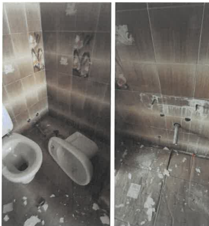
Fotografie 50 e 51 – sanitari che richiedono ripristini e reintegri – bagno piano primo
