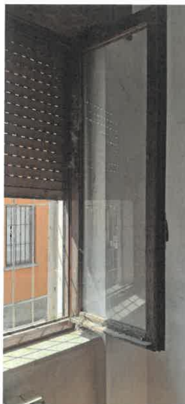
Fotografia 46 – serramenti esterni in legno e vetro semplice che richiedono ripristini - camera matrimoniale a piano primo da copertura
