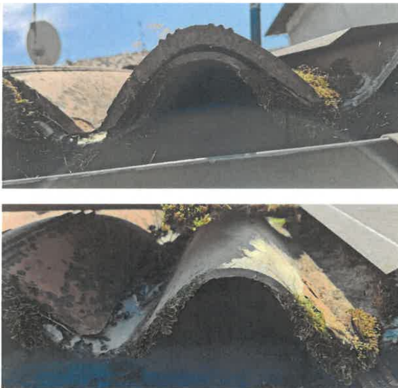
Fotografie 73 e 74 – sospetta presenza di onduline sotto coppi in cemento amianto
