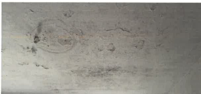
Fotografia 43 – fenomeni infiltrativi cucina a piano terra
