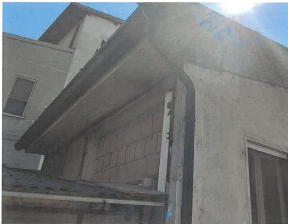
Fotografia 69 – prospetto Nord non conforme al Regolamento Locale di Igiene Tipo di Regione Lombardia punto 3.4.44 Spessore dei muri esterni “(...) in relazione ai materiali di costruzione impiegati, per la protezione dei locali dalle variazioni termiche e dall’azione degli agenti atmosferici.”
