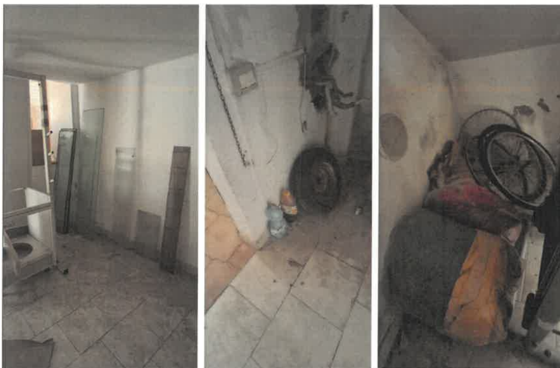
Fotografie 56, 57 e 58 – stoccaggio temporaneo rifiuti a piano terra
