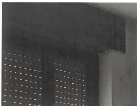
Fotografia 45 – ponti termici nella camera matrimoniale a piano primo
