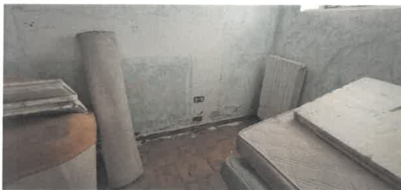
Fotografia 34 – fenomeni di umidità di risalita a piano terra
