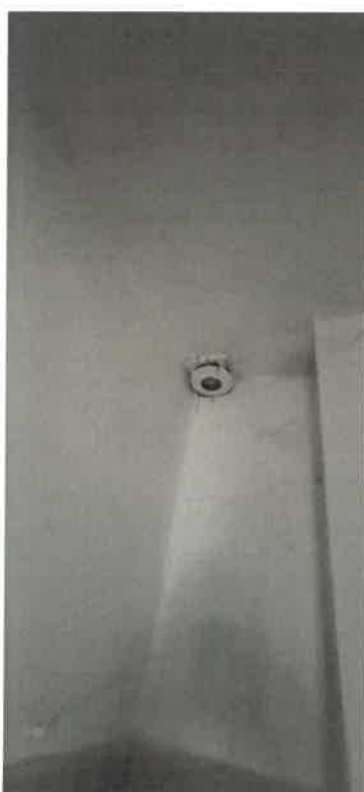
Fotografia 18 – estrazione forzata bagno a piano primo (da verificare funzionamento effettivo e il rispetto del Regolamento Locale di Igiene Tipo di Regione Lombardia punto 3.4.22 Stanze da Bagno e WC: superficie apribile minima per il ricambio di aria,
