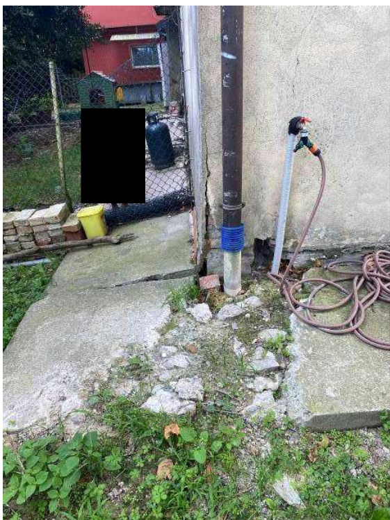
particolare degrado marciapiede
