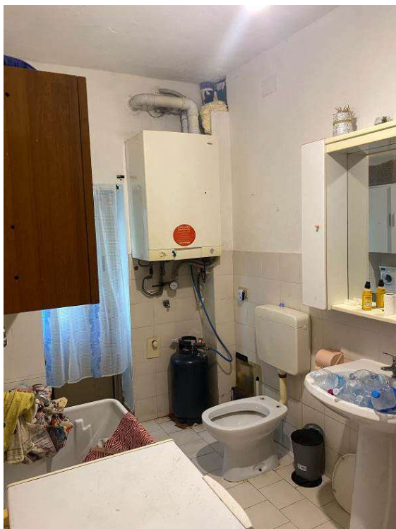
vista centrale termica-lavanderia
