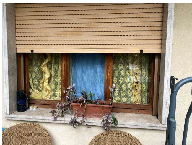
particolare degrado delle finestre
