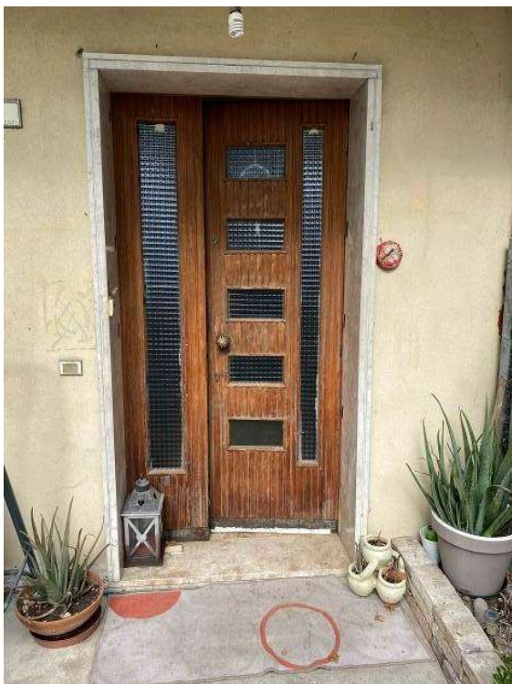
particolare degrado porta d'ingresso
