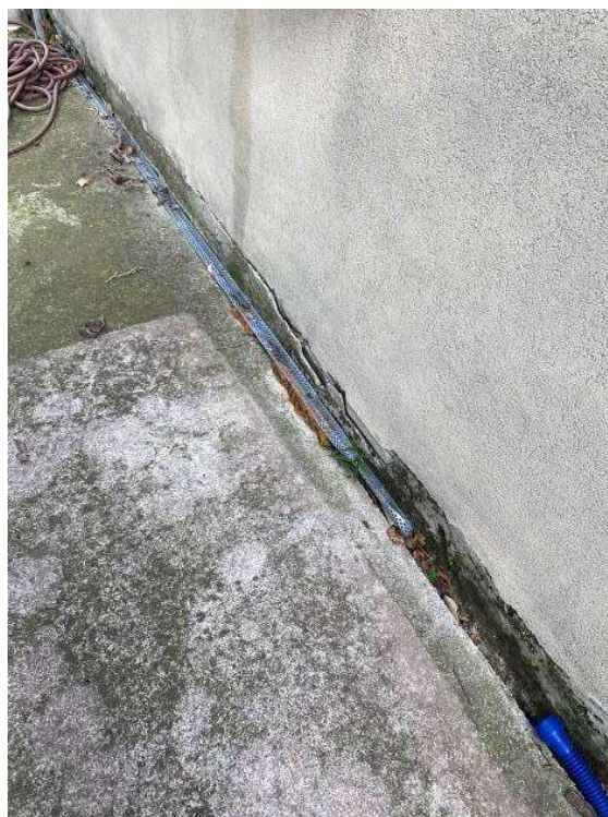
ulteriore particolare degrado marciapiede
