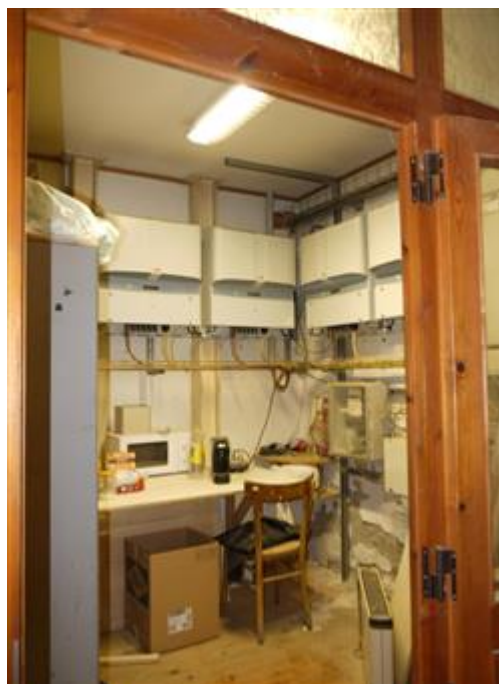
impianto centralina controllo interna
