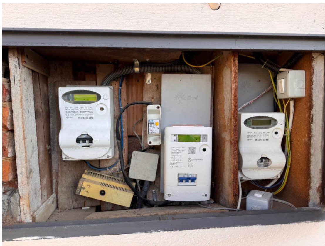
Contatore ENEL – quadro elettrico e magnetotermico
