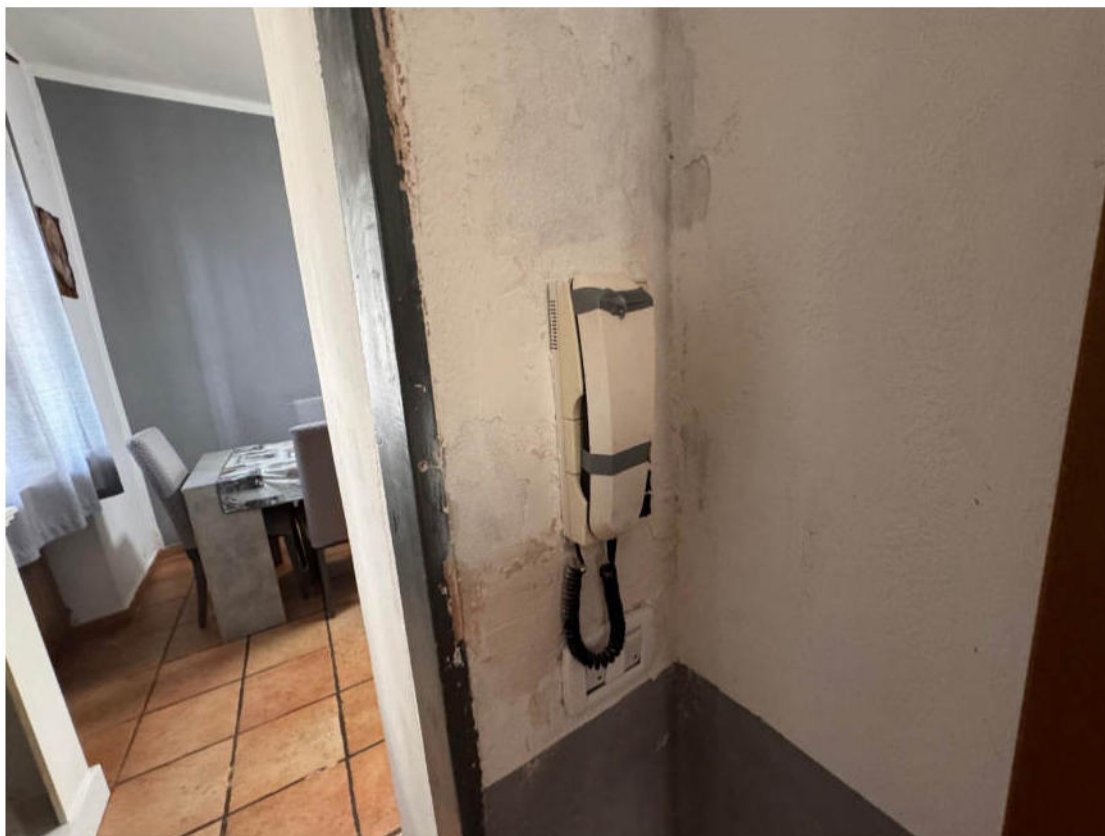
Corridoio – Citofono, particolare muro ammalorato
