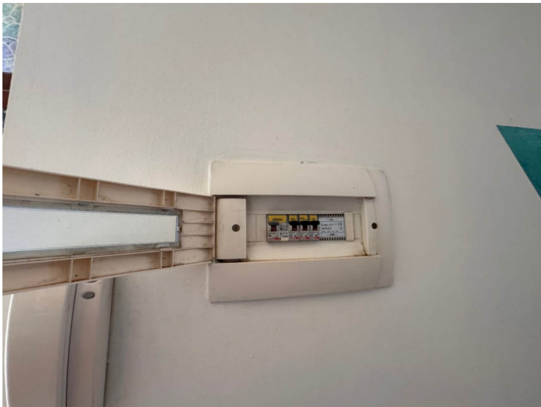
Particolare Centralino Elettrico
