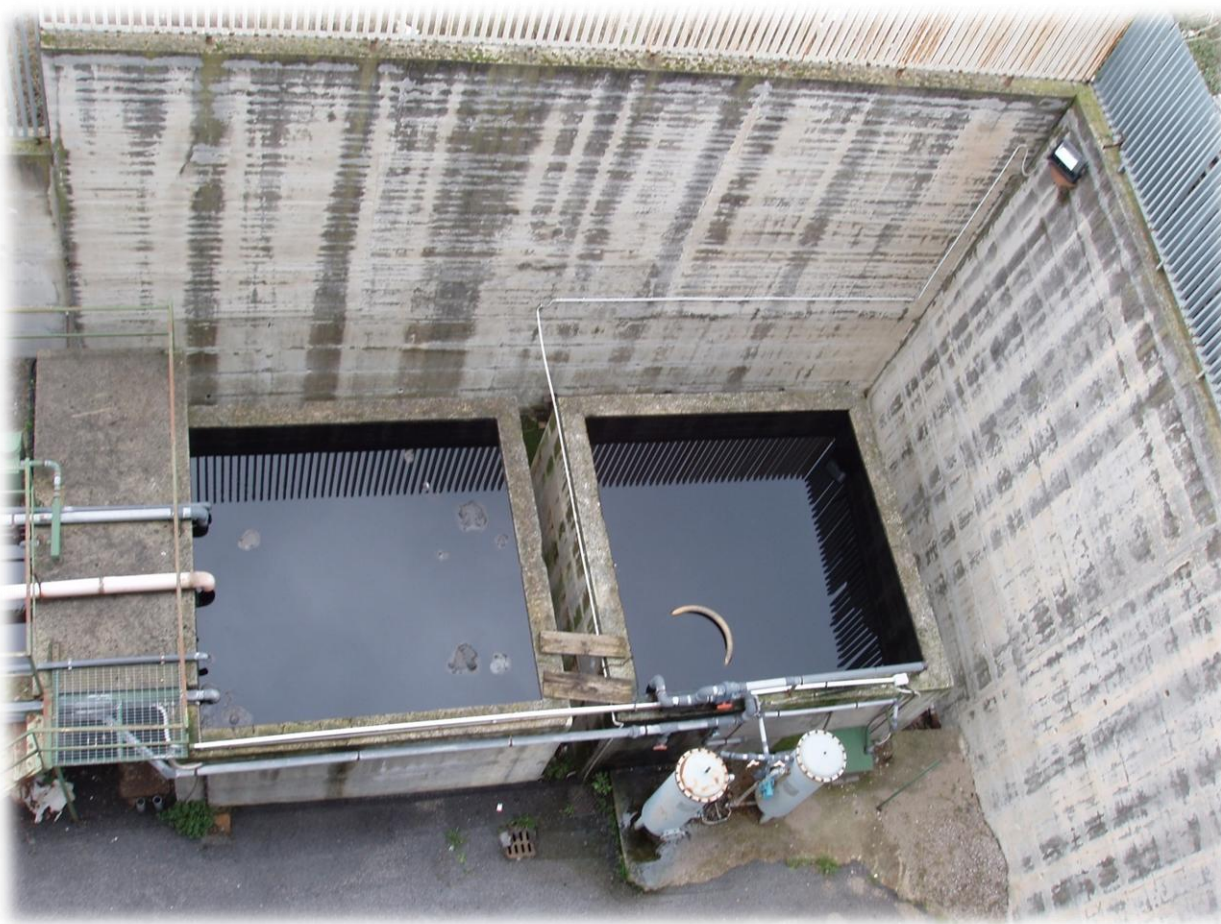
Foto n.34-35-36 – Vasche di depurazione
