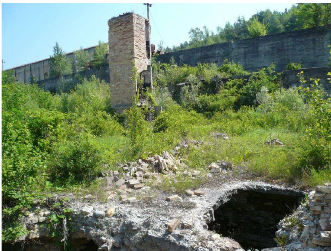
Foto 9- ruderi fabbricati e crolli piano interrato (anno 2018)
