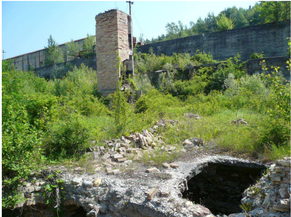
P.ed. 204 C.C. Vigo, particolare solai ad avvolto crollati
