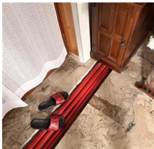
Tubazioni nuovo impianto a vista zona soggiorno
