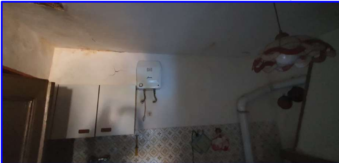
Particolare scaldabagno cucina
