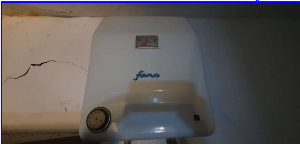
Particolare scaldabagno cucina
