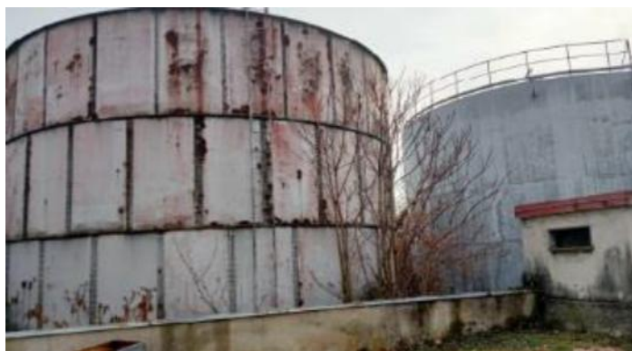
Figura 3.6 – Vista serbatoi Sa-1 e Sa-2.
