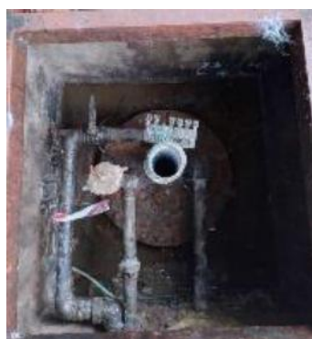
Figura 3.4 – Serbatoio Si-3 con relativo passo uomo.
