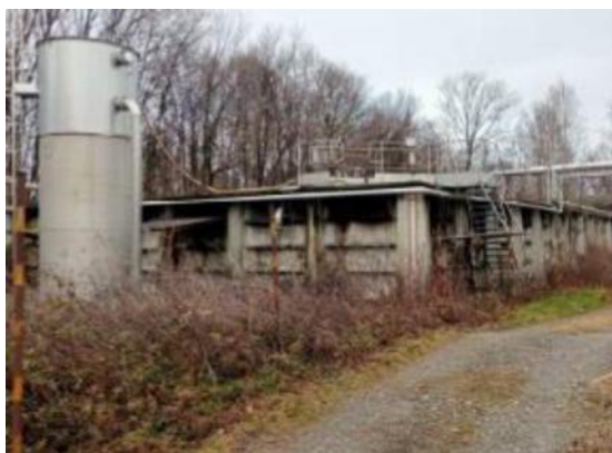
Figura 3.9 – Vista serbatoio Sa-5 (in metallo).
