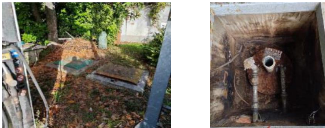
Figura 3.3 – Serbatoio Si-1 ed Si-2 con relativo passo uomo.
