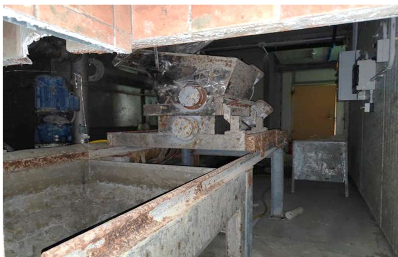
Foto 3- Vista del Sub.5 PT (Vano Tecnico per Fanghi)
