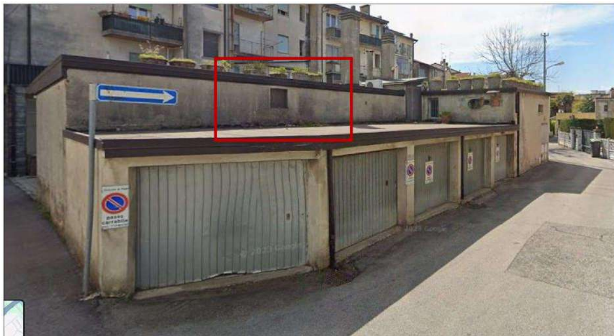
Vista della finestra non autorizzata
