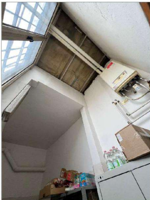
Vista della caldaia nel locale di servizio adiacente la cucina e dei boiler nel bagno per il personale
