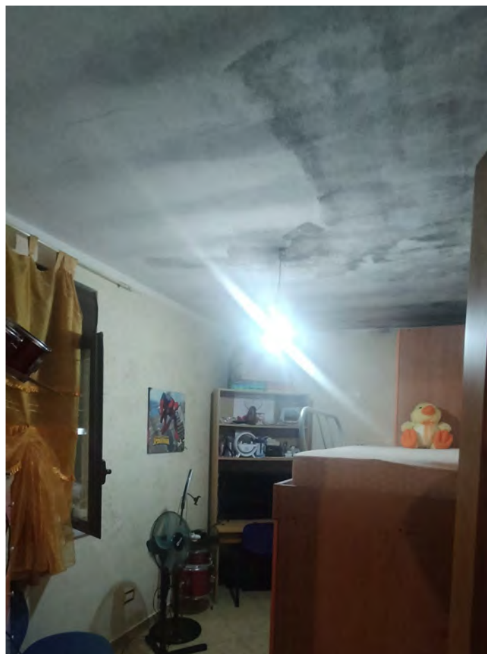
Foto 16 – Particolare condensa sul tetto della cameretta
