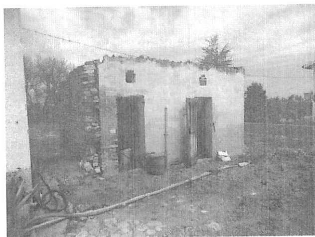
Foto 23 – Fabbicato fatiscente Sub. 6 – Unità Collabente
