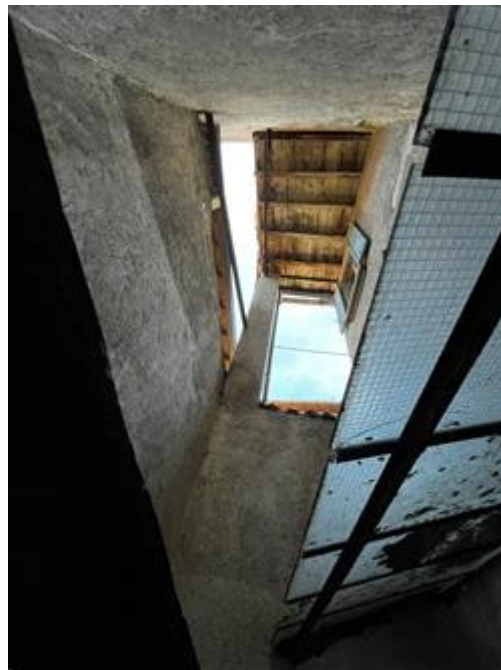
Il cavedio a confine
