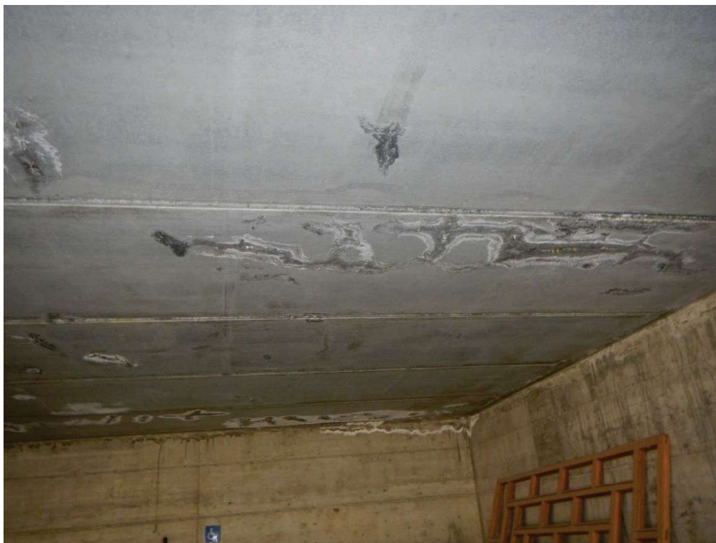
Foto 37: segni di infiltrazione
