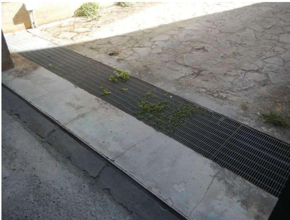
Foto 43: grigliato in corrispondenza del cancello scorrevole
