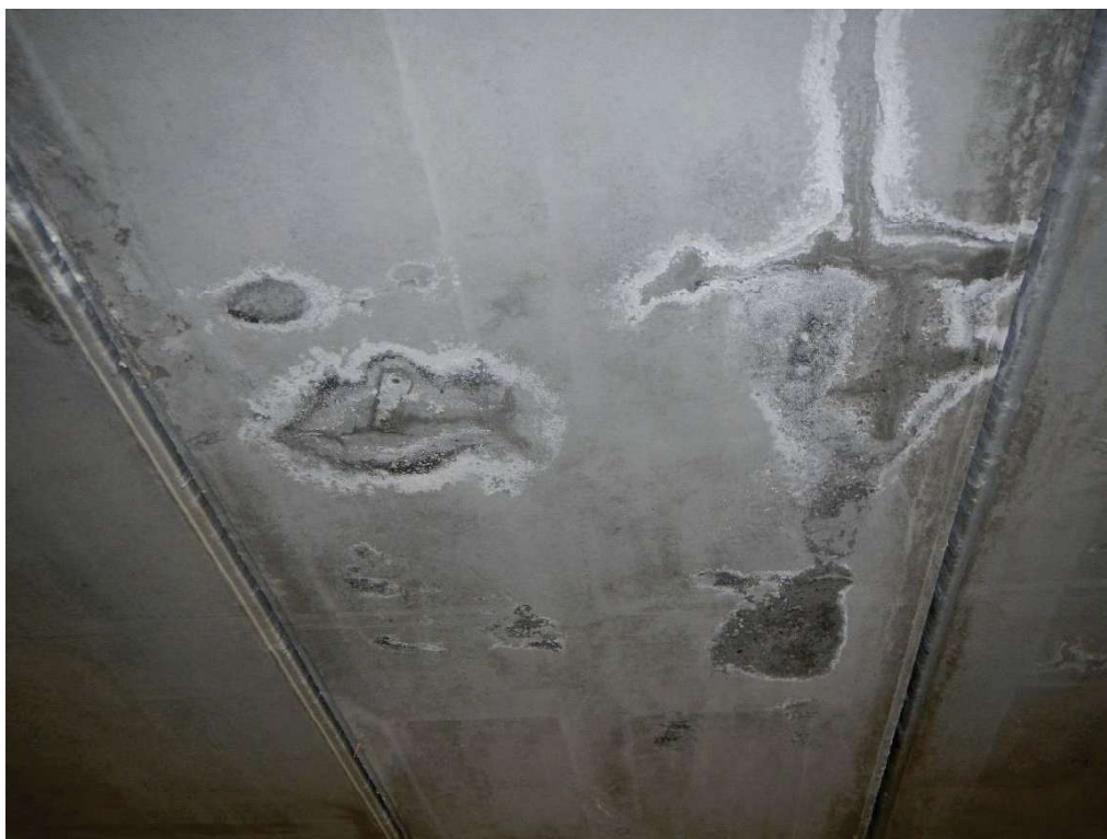
Foto 36: segni di infiltrazione
