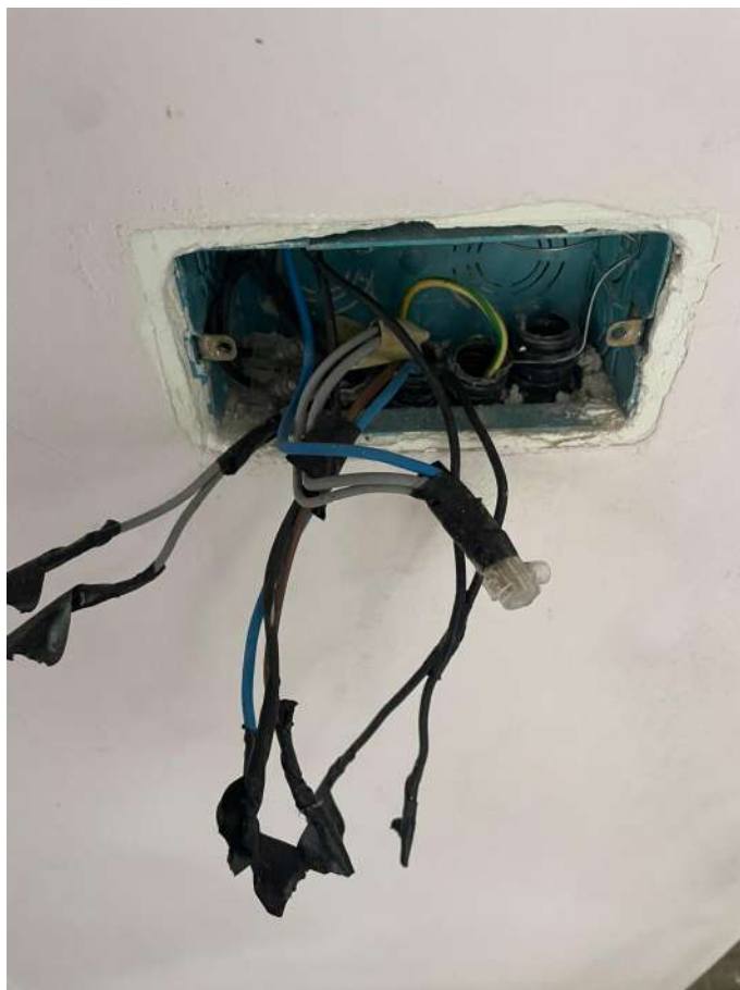
Foto 27 – Dettaglio dell'impianto elettrico
