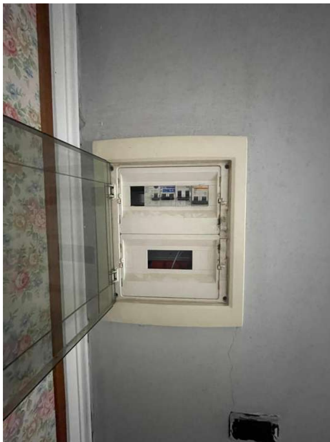
Foto 25 – Dettaglio dell'impianto elettrico
