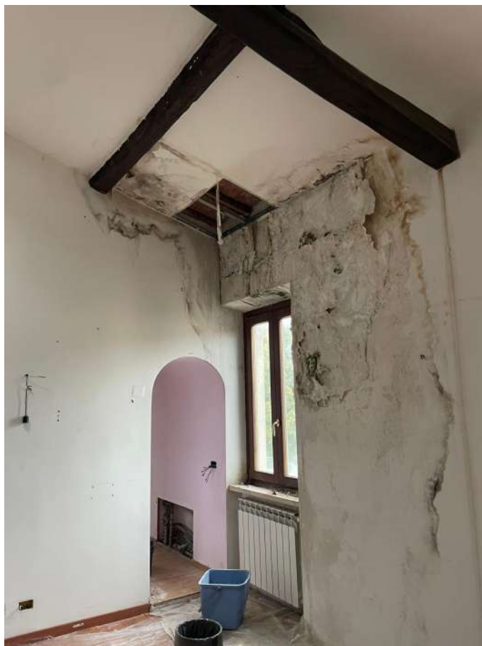
Foto 21 – Vista delle infiltrazioni
