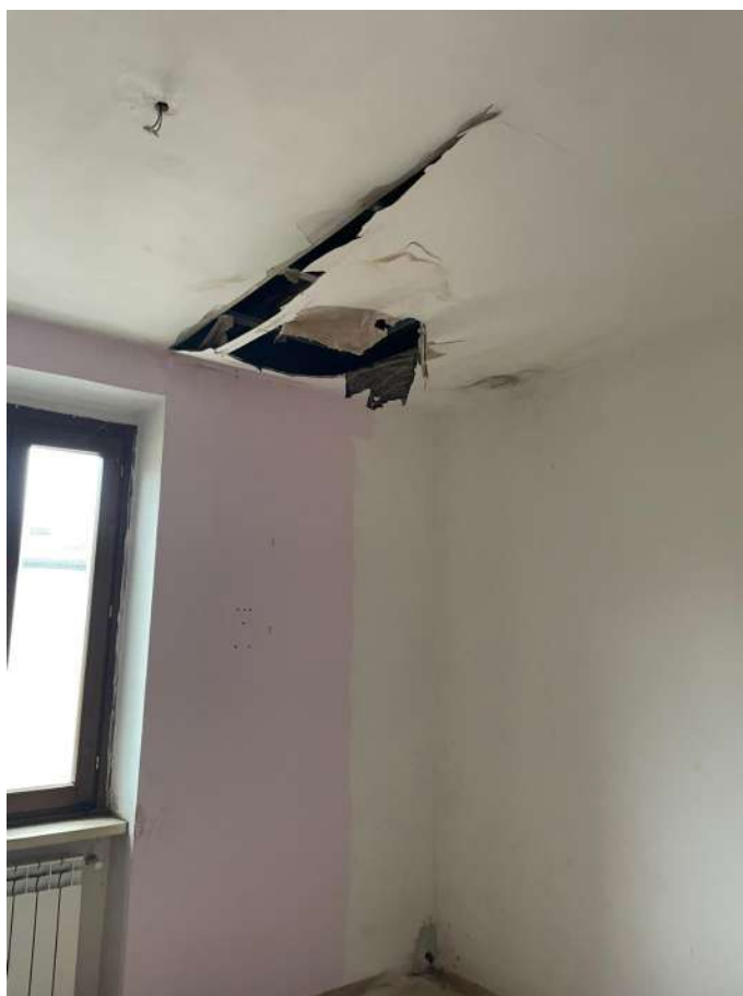
Foto 20 – Vista delle infiltrazioni
