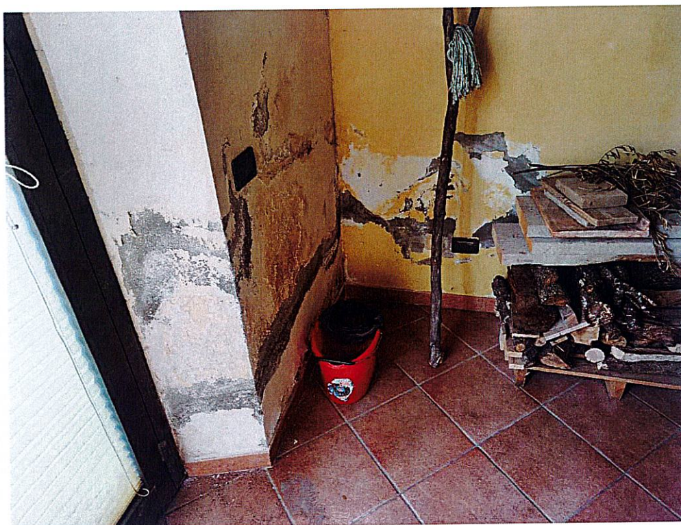
Foto 9 - Infiltrazioni di umidità dal basso
