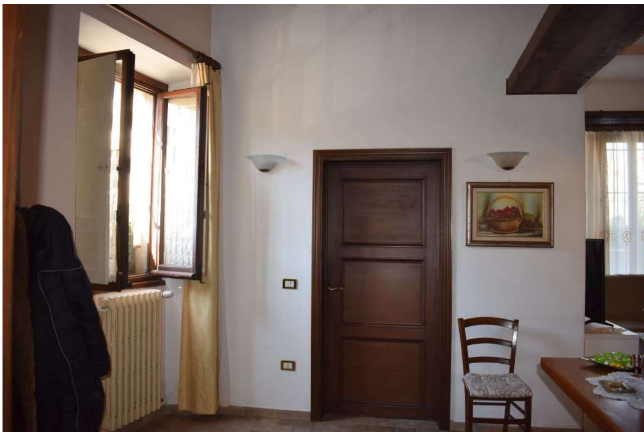
Foto n. 8 _ Sopralluogo del 13/02/2024 Appartamento piano terra. Ingresso/cucina/soggiorno. La porta di accesso allo studio
