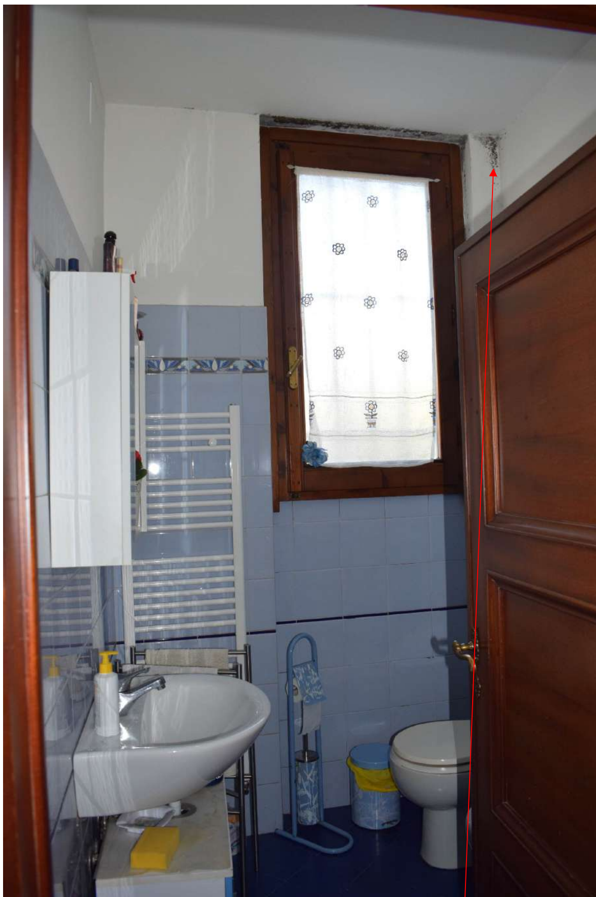
Foto n. 12 _ Sopralluogo del 13/02/2024 Appartamento piano terra. Bagno. Si nota condensa e muffa
