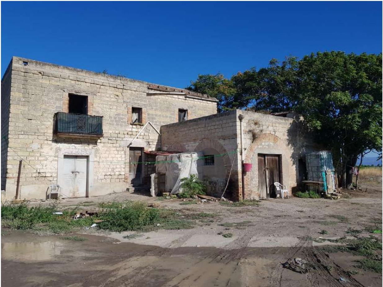
Foto 1 – Vista accessi fabbricato diruto
