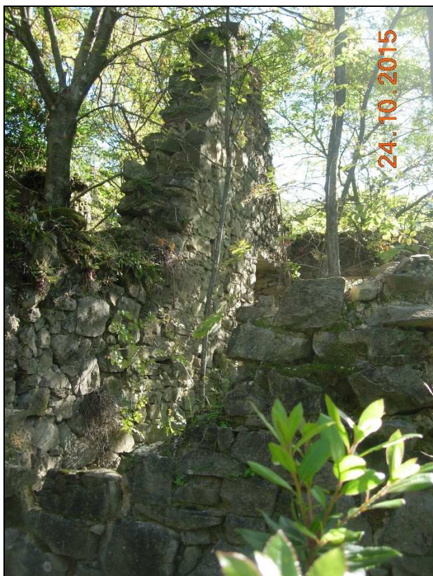
CORPO B EDIFICIO COLLABENTE
