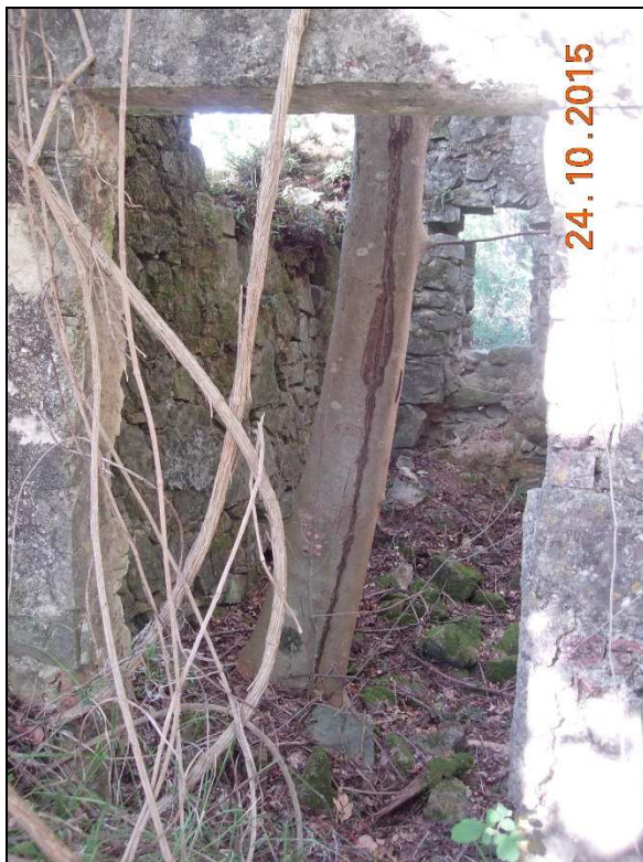
CORPO B EDIFICIO COLLABENTE
