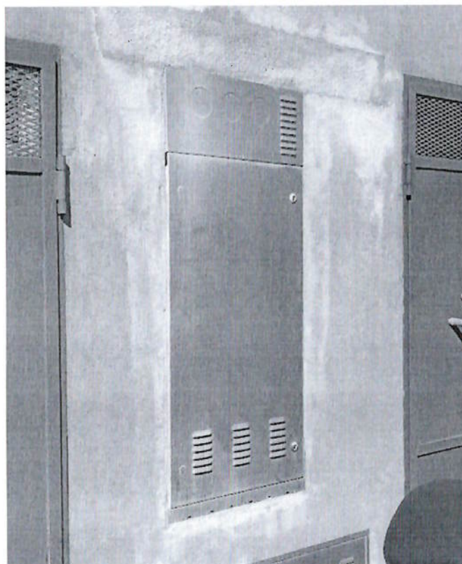
Foto n° 12 – caldaia imp. Termico al piano terra
