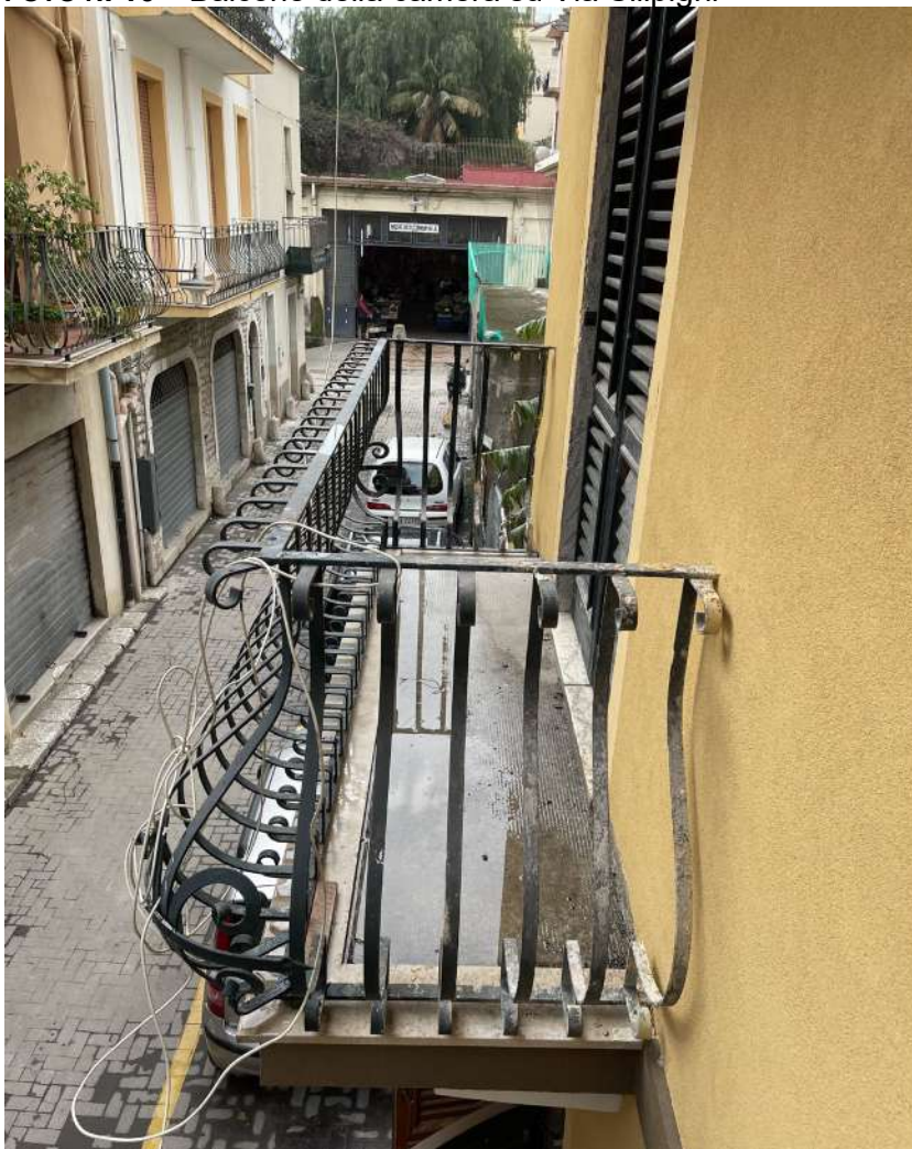
FOTO N. 10 – Balcone della camera su Via Silipigni
