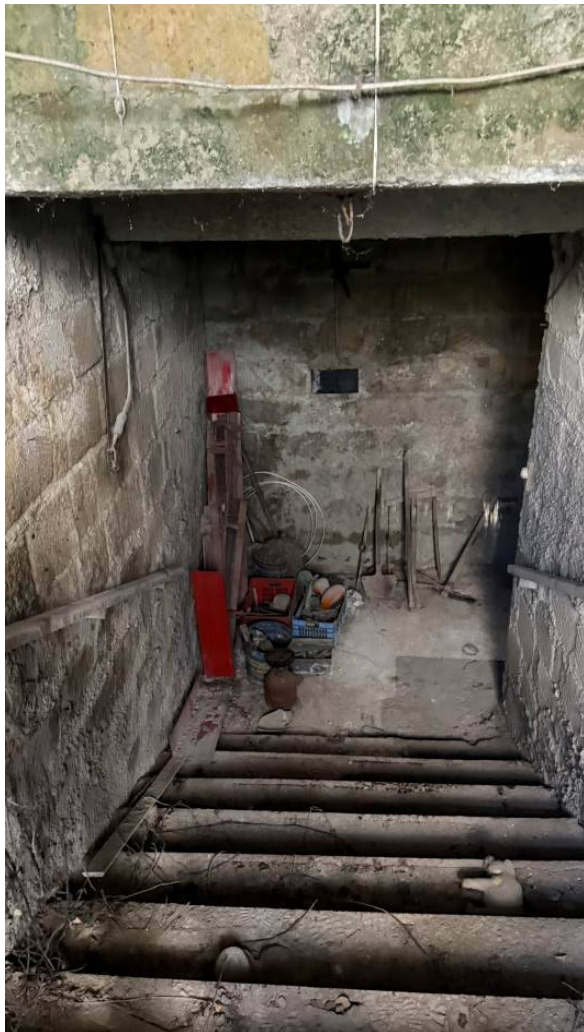
Foto 20 – Ingresso al sub 4
