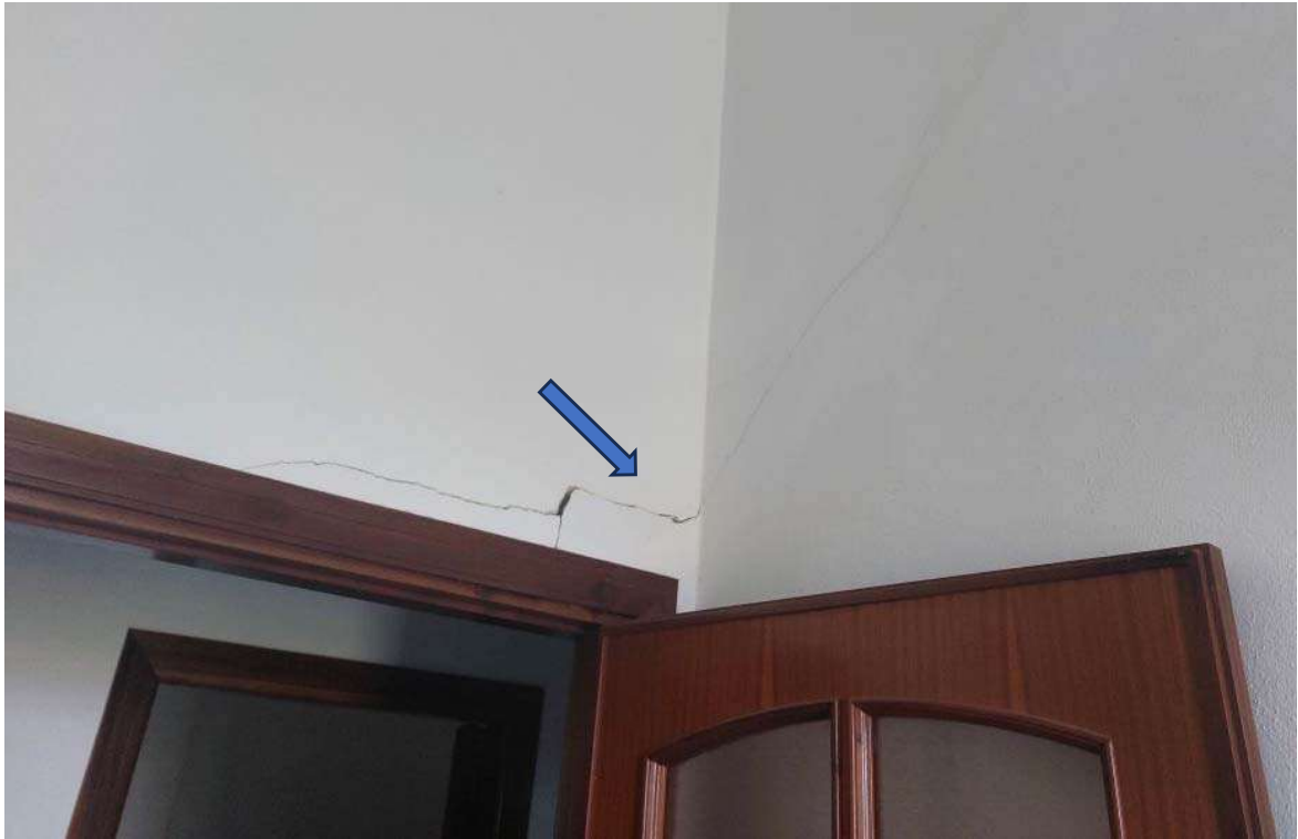
Foto dettaglio lesioni da cedimenti strutturali
