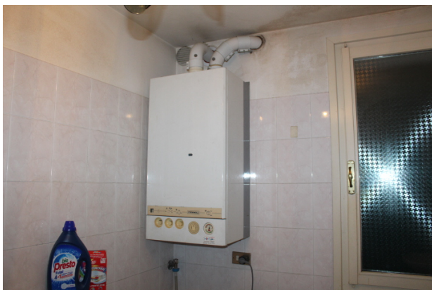
PARTICOLARE DELLA CALDAIA
