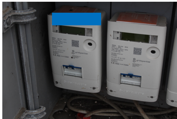
PARTICOLARE DEI CONTATORI DELL'ENERGIA ELETTRICA
