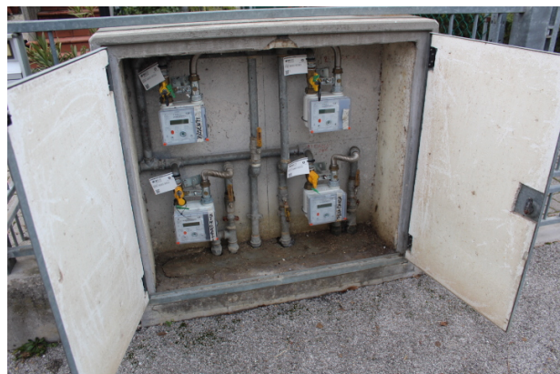
VEDUTA DELLA NICCHIA CONTATORI DEL GAS UBICATA IN AFFACCIO ALLA VIA MORETTI
