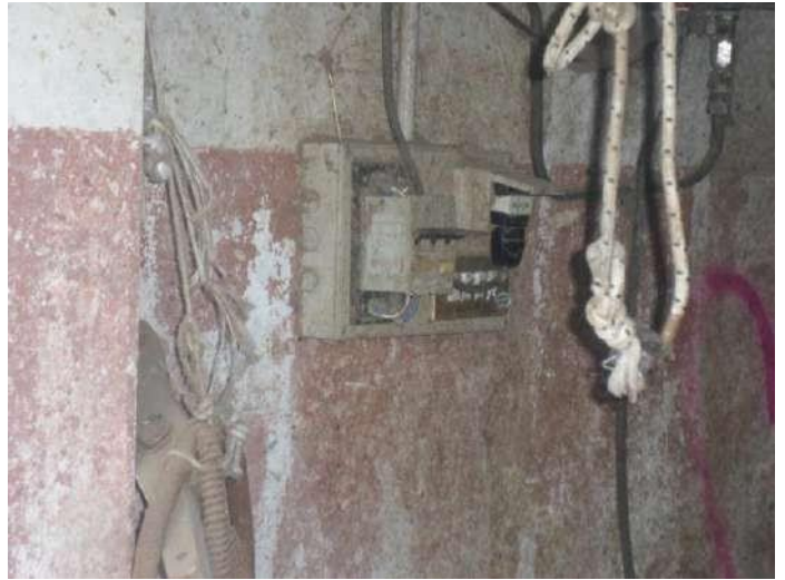
dettaglio impianto elettrico
