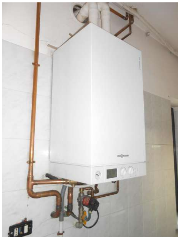
immagine 25 – generatore di calore autonomo
