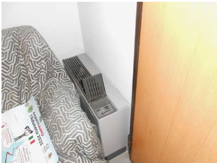
immagine 26 – particolare termoconvettore
