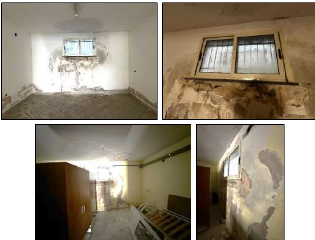
Figura 53 - Fenomeni infiltrativi in corrispondenza delle aperture
