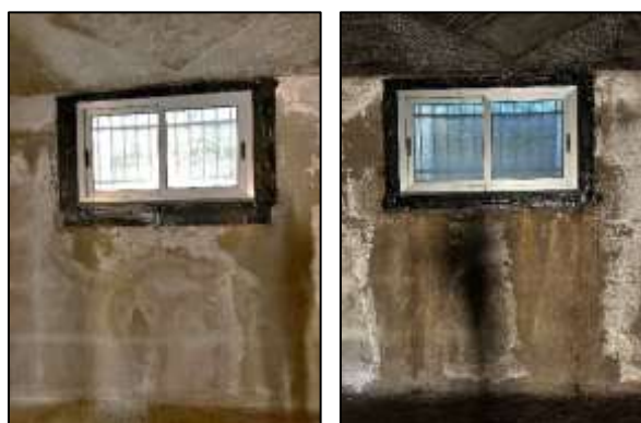
Figura 50 - fenomeni infiltrativi in prossimità delle aperture
