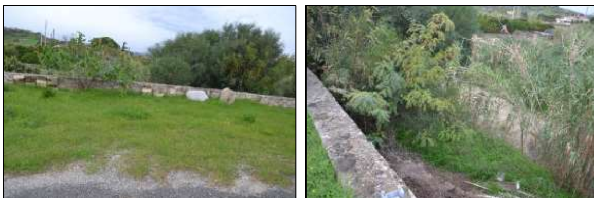
Figura 21 - Canale di scolo
