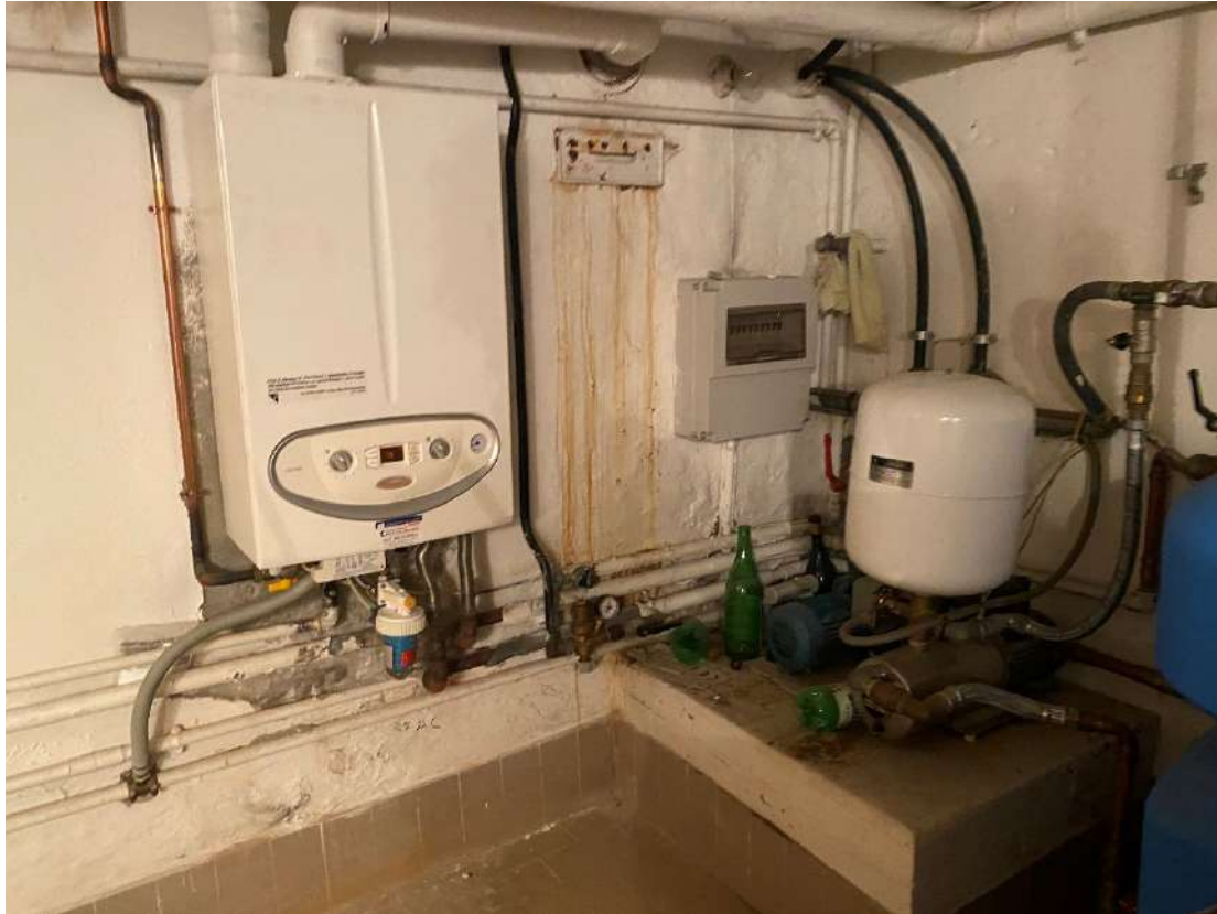
Vista della caldaia autonoma ubicata in cantina nella zona interrata
