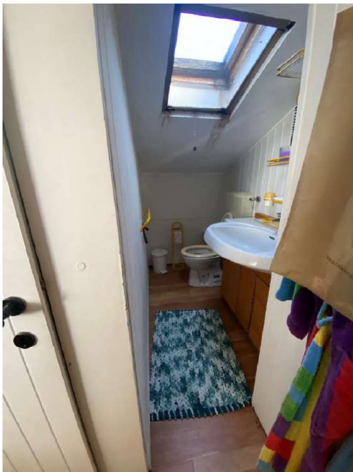
Vista del bagno all'ultimo livello sottotetto, non regolare per le altezze ridotte
