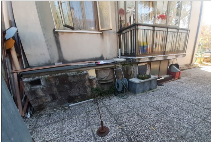
Basso manufatto abusivo a ridosso del fabbricato
