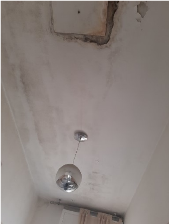
Particolare delle infiltrazioni presenti sui soffitti
