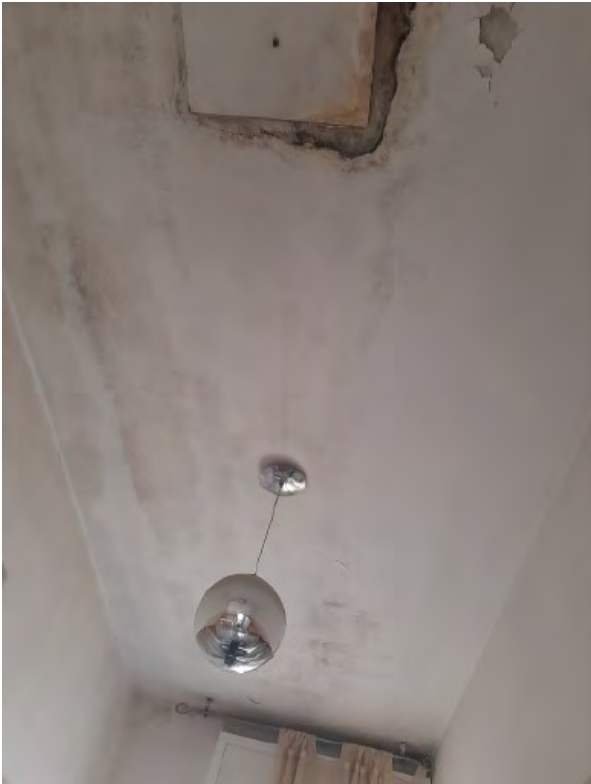
Particolare delle infiltrazioni presenti sui soffitti
