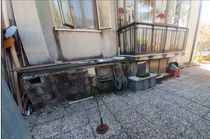
Basso manufatto abusivo a ridosso del fabbricato
