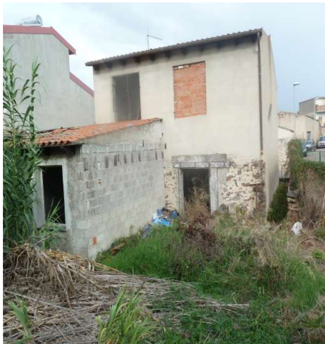
Foto prospetto posteriore con vano abusivo
