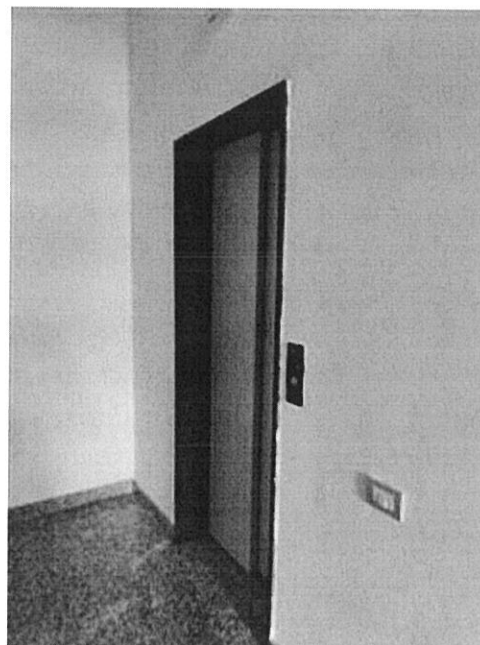
ascensore (non arriva al piano terzo)
