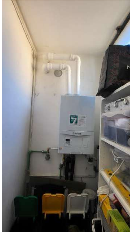
Caldaia autonoma a gas metano per riscaldamento e produzione acqua calda
