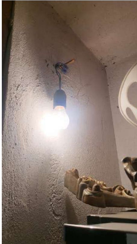
Impianto elettrico della cantina pignorata
