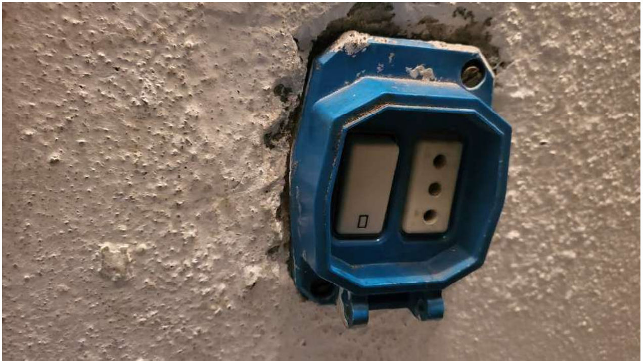
Impianto elettrico della cantina pignorata
