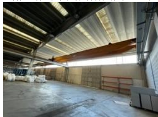
Vista CARRIPONTE condotta da STAMPLAST
