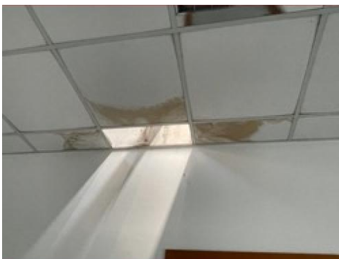
Vista interna uffici p1 interni lotto Con presenza infiltrazioni
