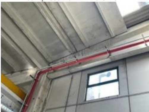
Vista da cui si rileva percolatura di acqua dalle pareti
