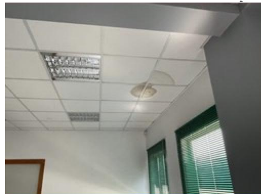
Vista interna uffici p1 interni lotto Con presenza infiltrazioni
