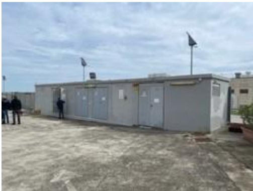
Vista cabina MT interna lotto
