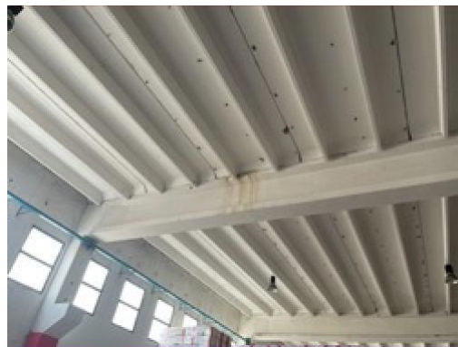
Vista da cui si rileva percolatura di acqua dalle pareti capannone
