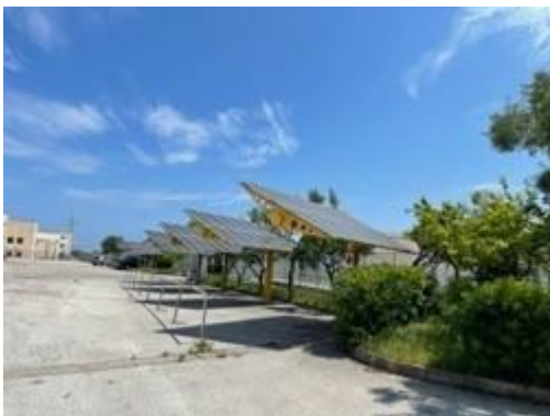
Vista fotovoltaico a terra lotto 1
