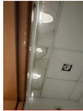
Vista interna uffici p1 interni lotto Con presenza infiltrazioni
