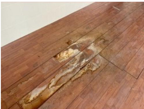
Vista interna pl interni lotto Con presenza infiltrazioni
