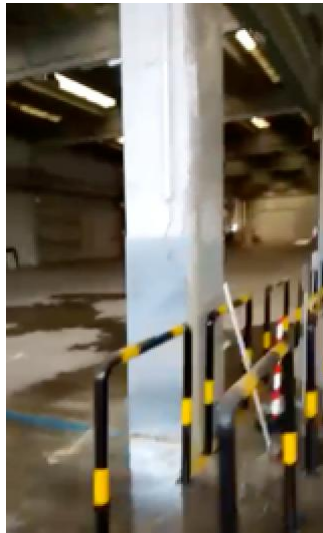
Vista che evidenzia infiltrazioni
