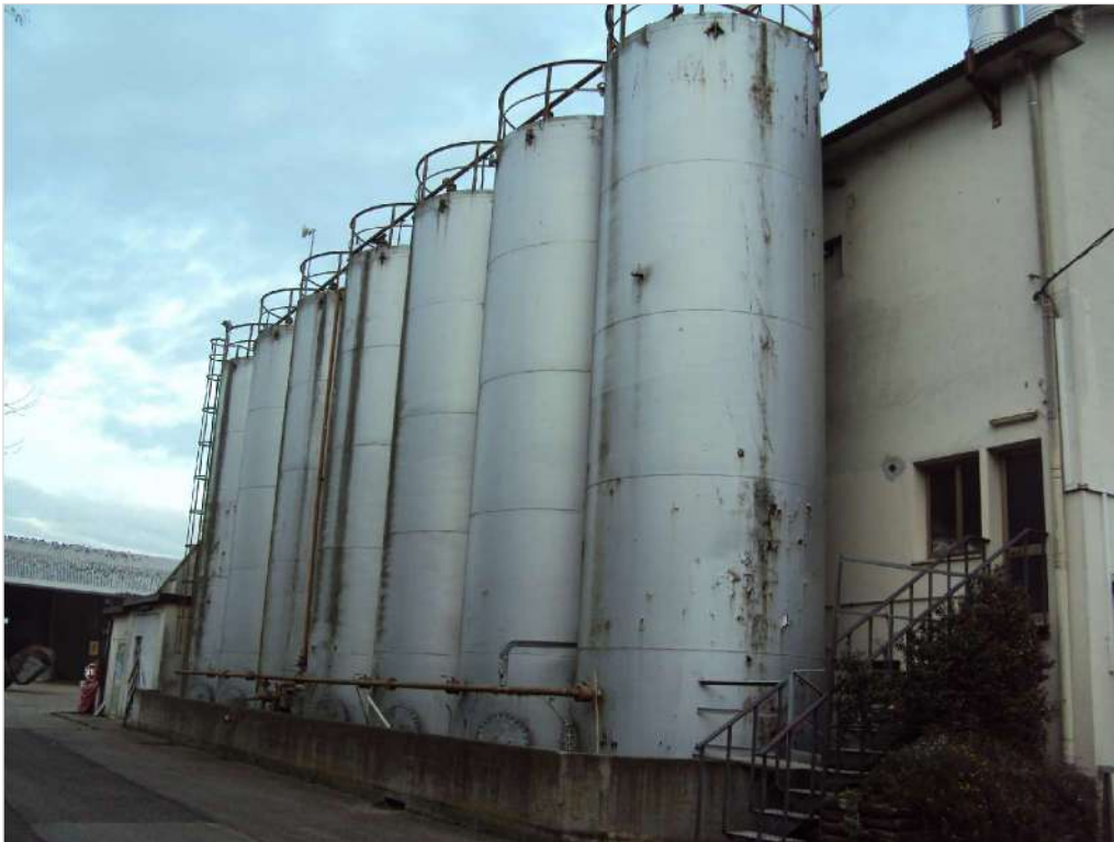
Rif. n. 5a: Silos per olio vegetale da 600 q.li (in corso di revisione)
