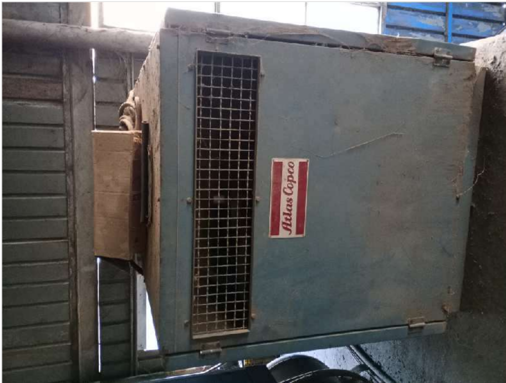
Rif. n. 33: Compressore a vite ATLAS COPCO GA 308 (obsoleto)
