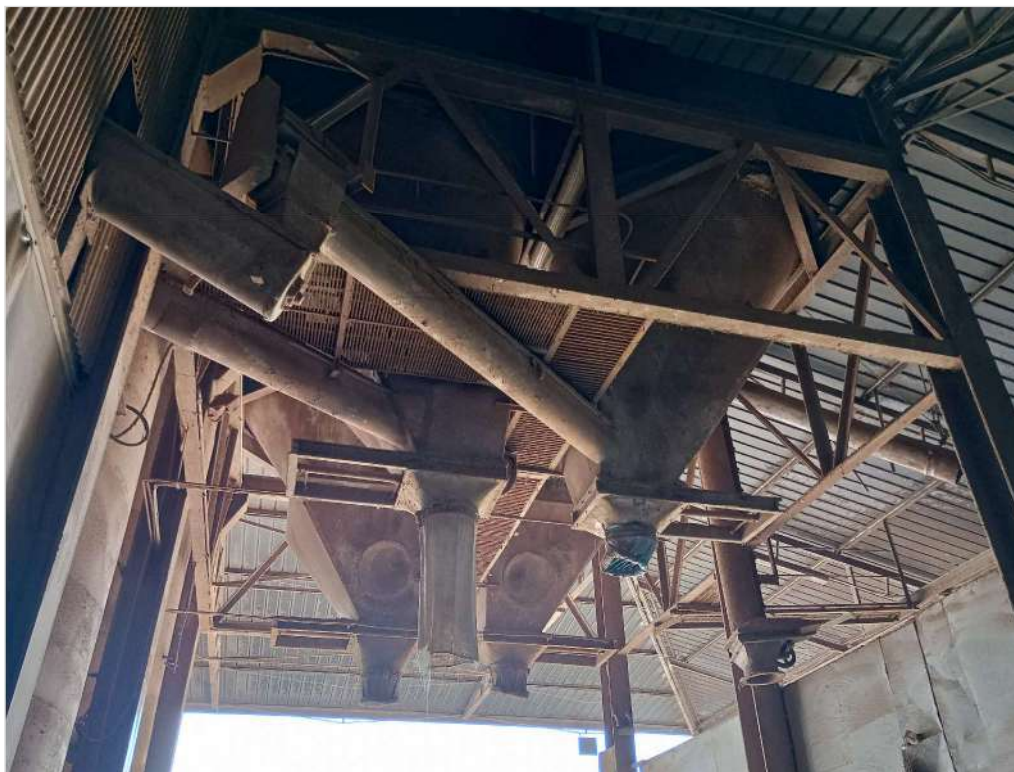
Rif. Silos farine vegetali
