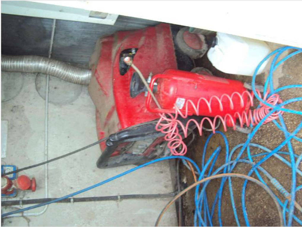
Rif. n. 34: Idropulitrice con caldaia a gas per produzione acqua calda lavaggio mezzi
