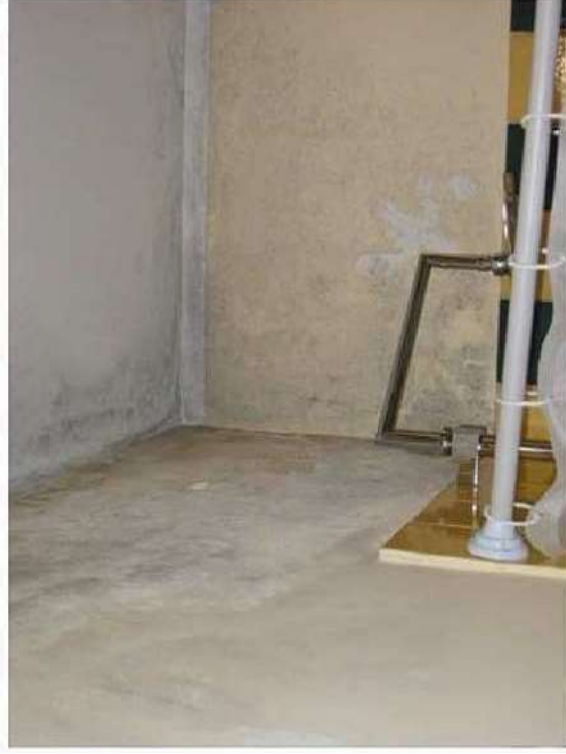
Presenza di umidità e muffe diffuse - W.C. - doccia - P. II°
