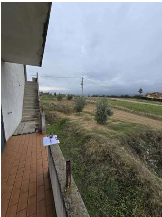
Foto 21: vista scala esterna di accesso al piano primo, non ultimata
