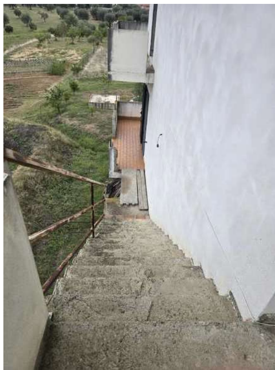
Foto 22: vista scala esterna di accesso al piano primo, incompleta
