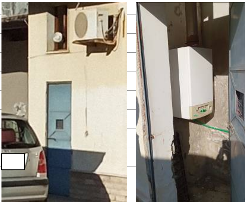
Foto 32 e 33 _Vista del locale caldaia accessibile dalla corte esterna
