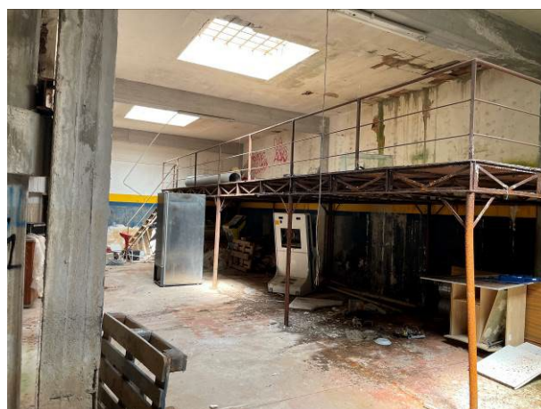
Foto 18 – piccolo soppalco in acciaio
