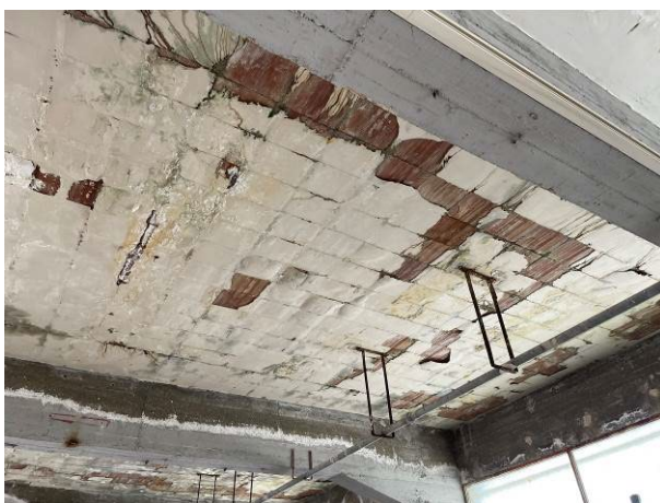
Foto 9 – stato di degrado dei solai di copertura
