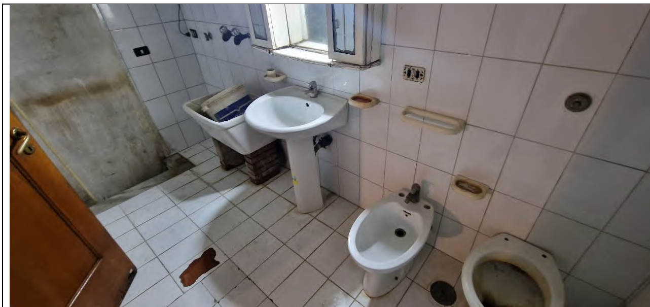
Foto n. 7 – Lotto 1 – Locale bagno p.lla 871 sub 2 con porta murata
