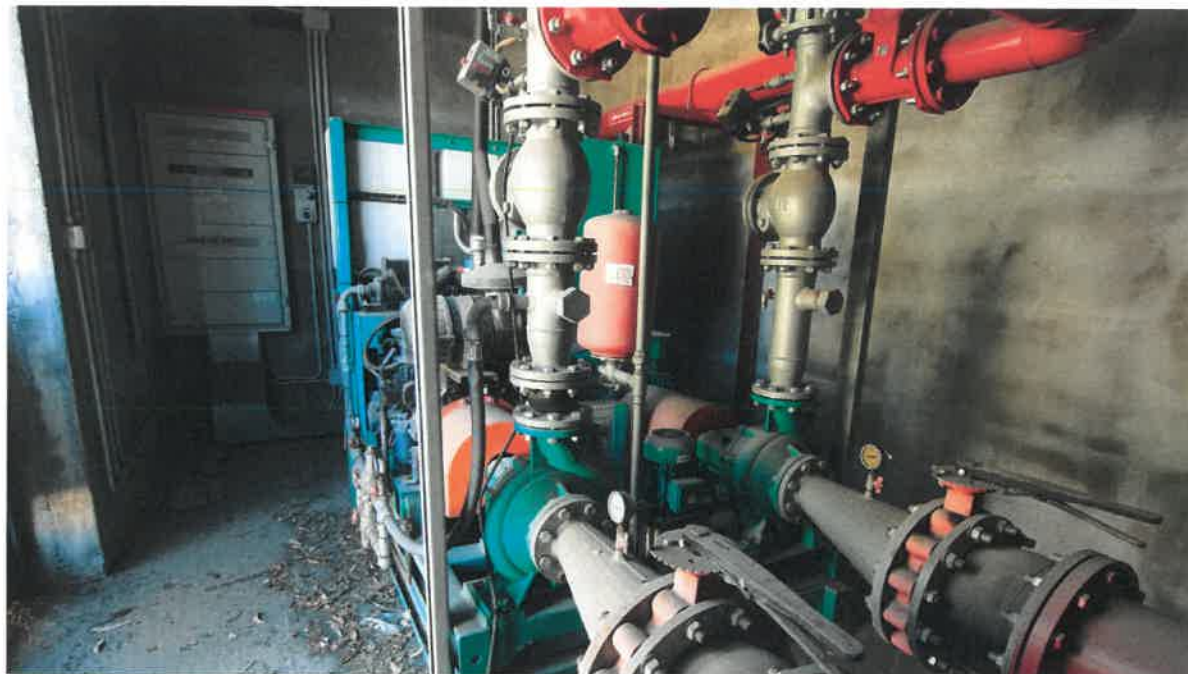
Interno centrale antincendio e gruppi di pressurizzazione
