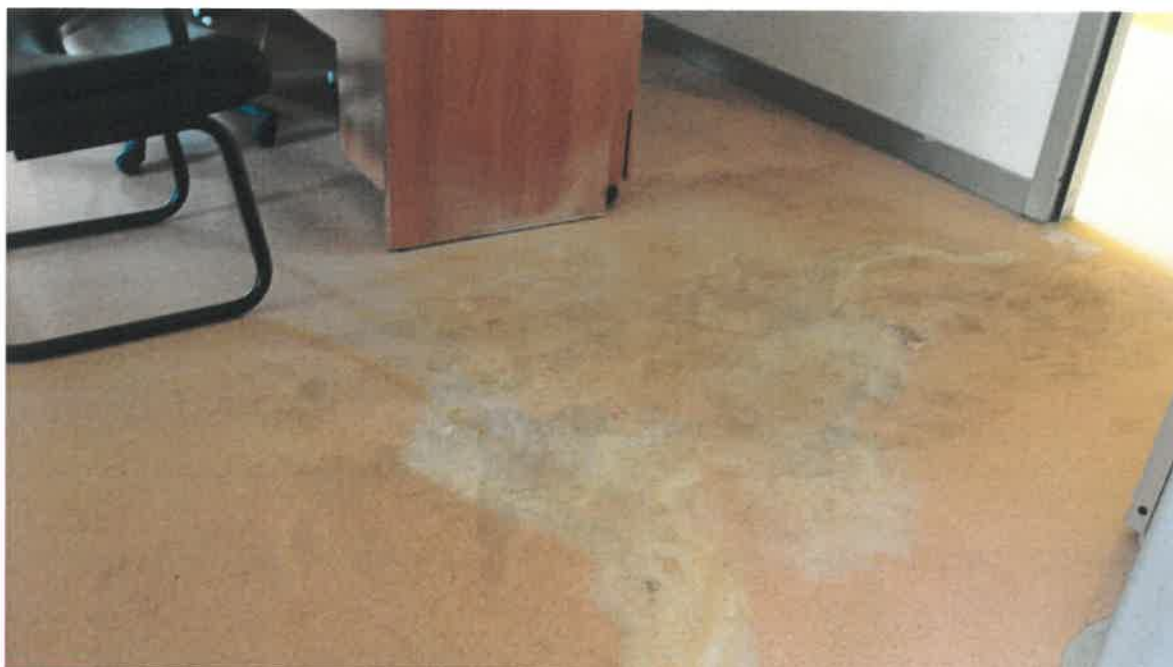
E55 - Interno ufficio piano 2 - Evidenti le infiltrazioni
