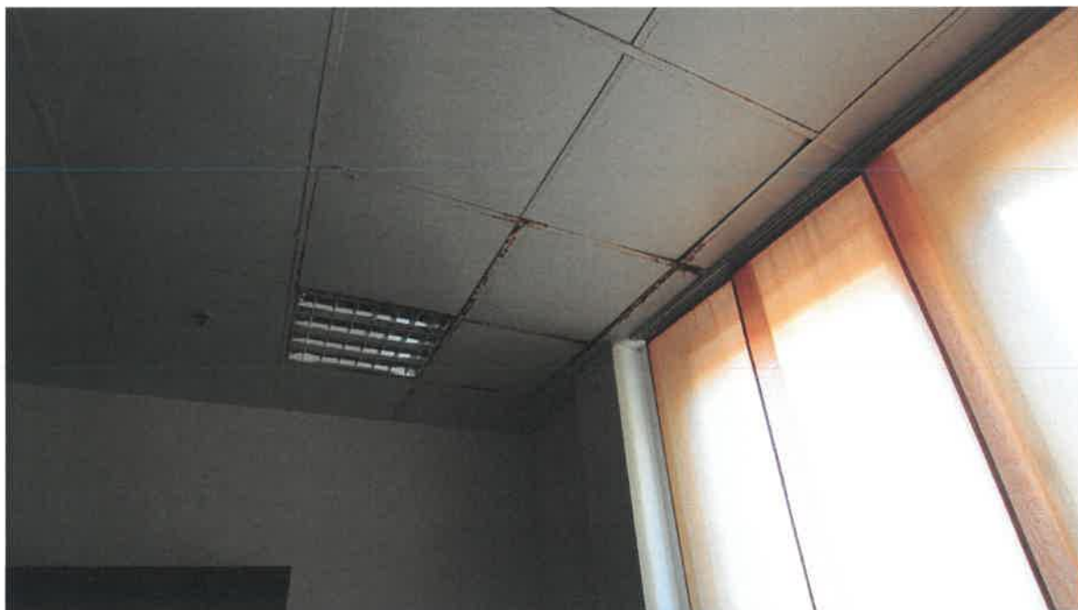
E55 - Interno ufficio piano 2 - Evidenti le infiltrazioni
