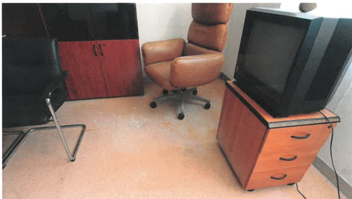
E55 - Interno ufficio piano 2 - Evidenti le infiltrazioni
