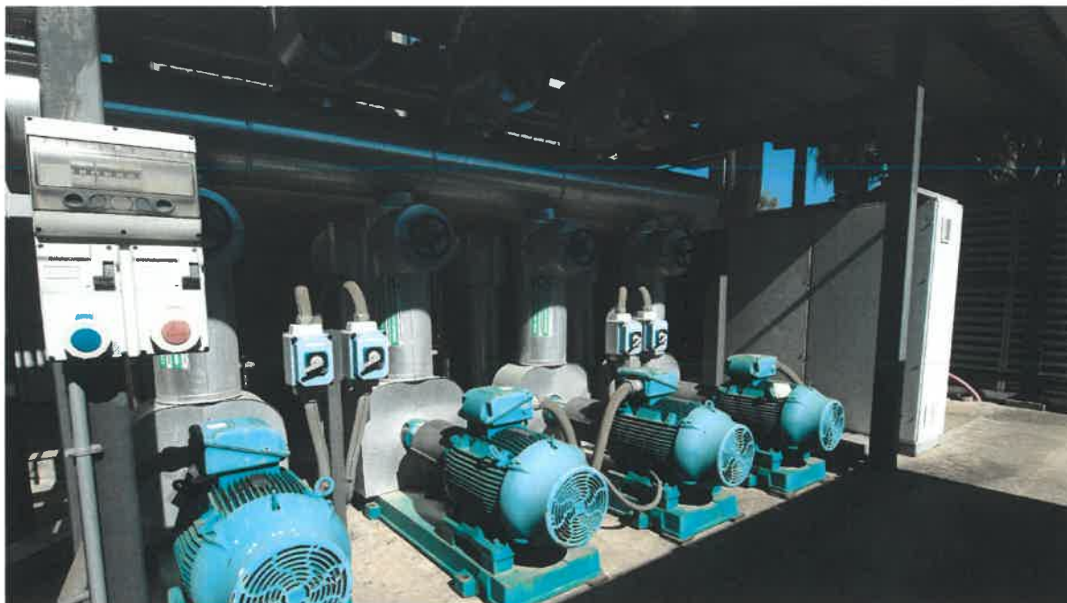
E55 - lato Nord. Gruppo pompe di circolazione acquafredda
