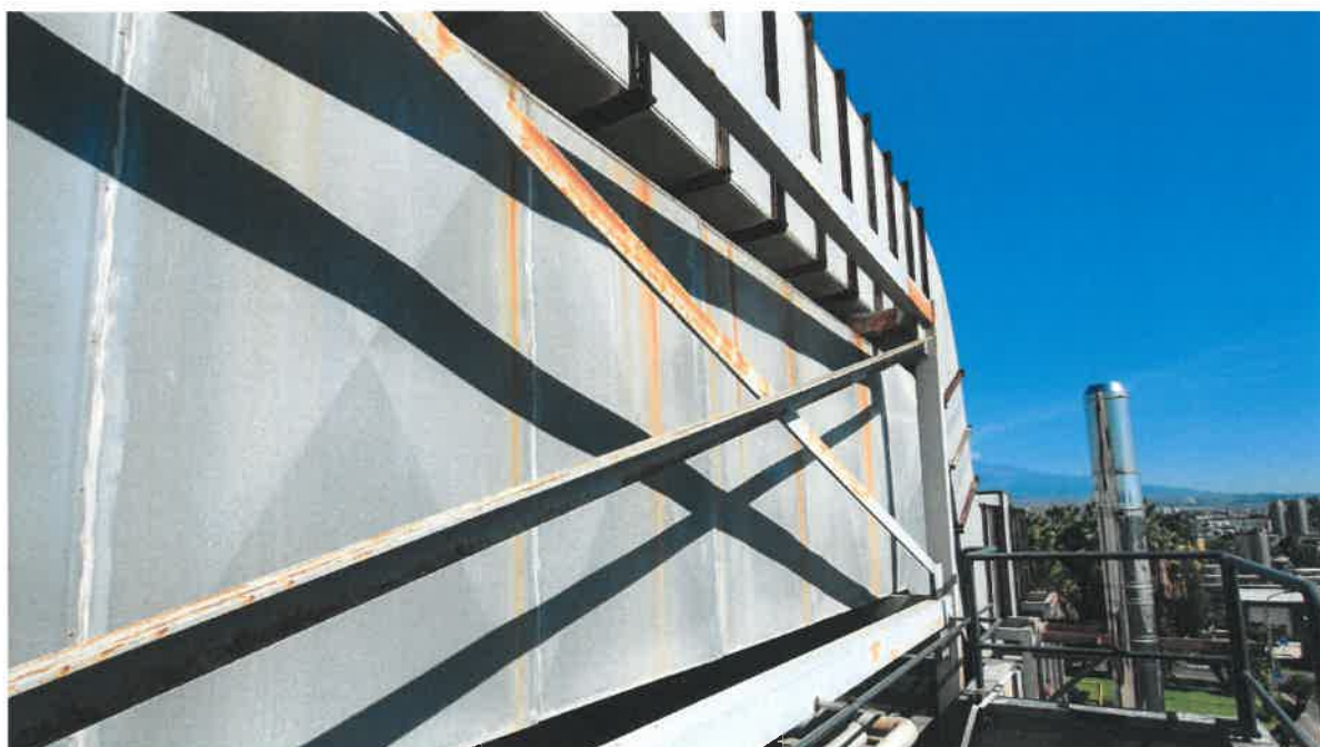
E55 - lastrico solare - Le strutture di sostegno delle canalizzazioni aria sono fortemente ossidate
