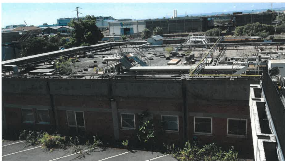
E33 - Vista dello stato di abbandono della terrazza di copertura
