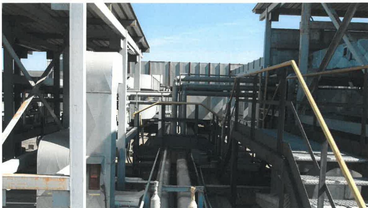
E55 - Lastrico solare: tettoie, andatoie e passerelle a servizio degli impianti
