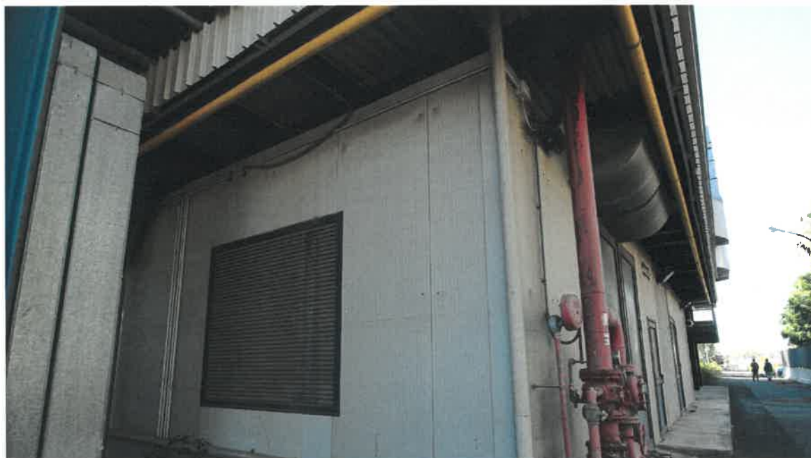
E55 - lato ovest. Partenza rete impianto sprinkler non più efficiente
