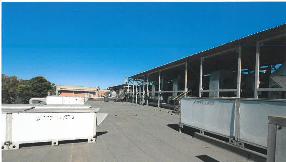
E55 - Lastrico solare: tettoie di protezione delle partenze dei cavi verticali. UTA ossidate
