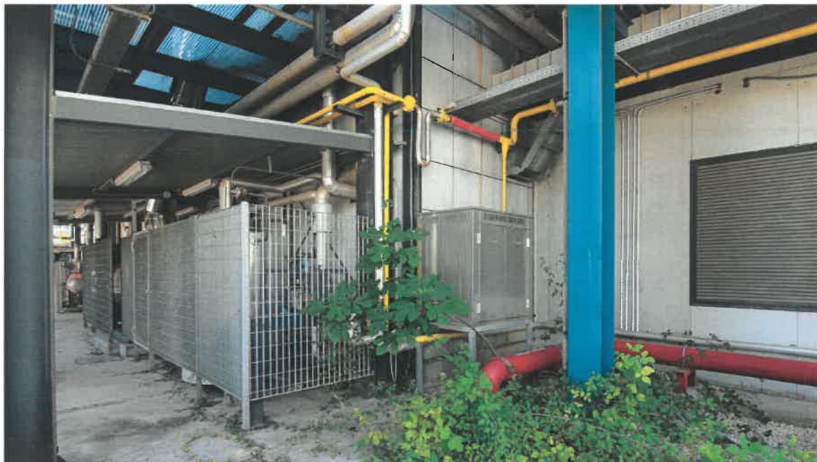
E55 - Rack Nord lato recinzione con stabilimento Pfizer. Evidente la mancata manutenzione
