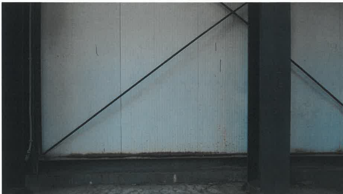
E55 - Rack Nord - Ossidazione delle strutture principali
