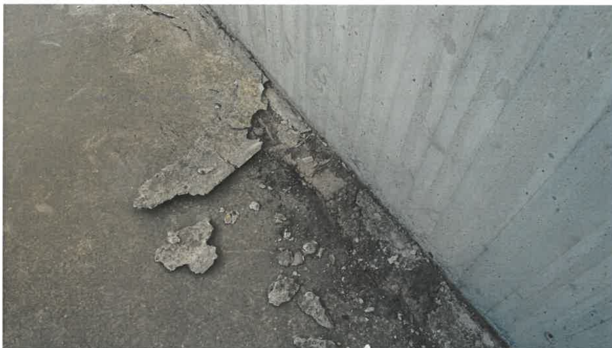
E55 - lato est. Scala di emergenza in c.a. - Particolare delle condizioni di degrado della parete
