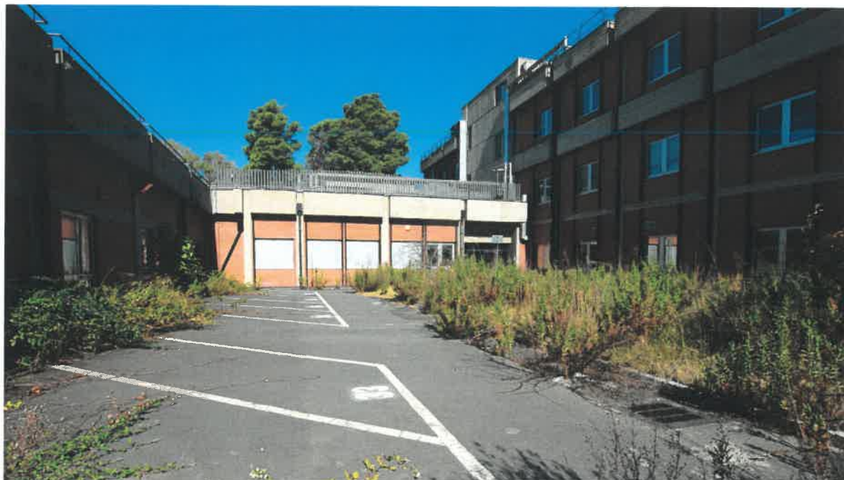
E55 - lato sud e vista corte interna - Evidente la vegetazione spontanea
