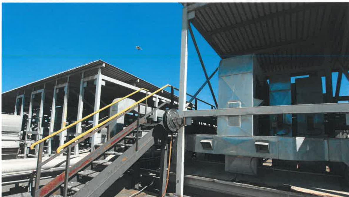
E55 - Lastrico solare: tettoie, andatoie e passerelle a servizio degli impianti. Necessità di manutenzione alle parti ossidate
