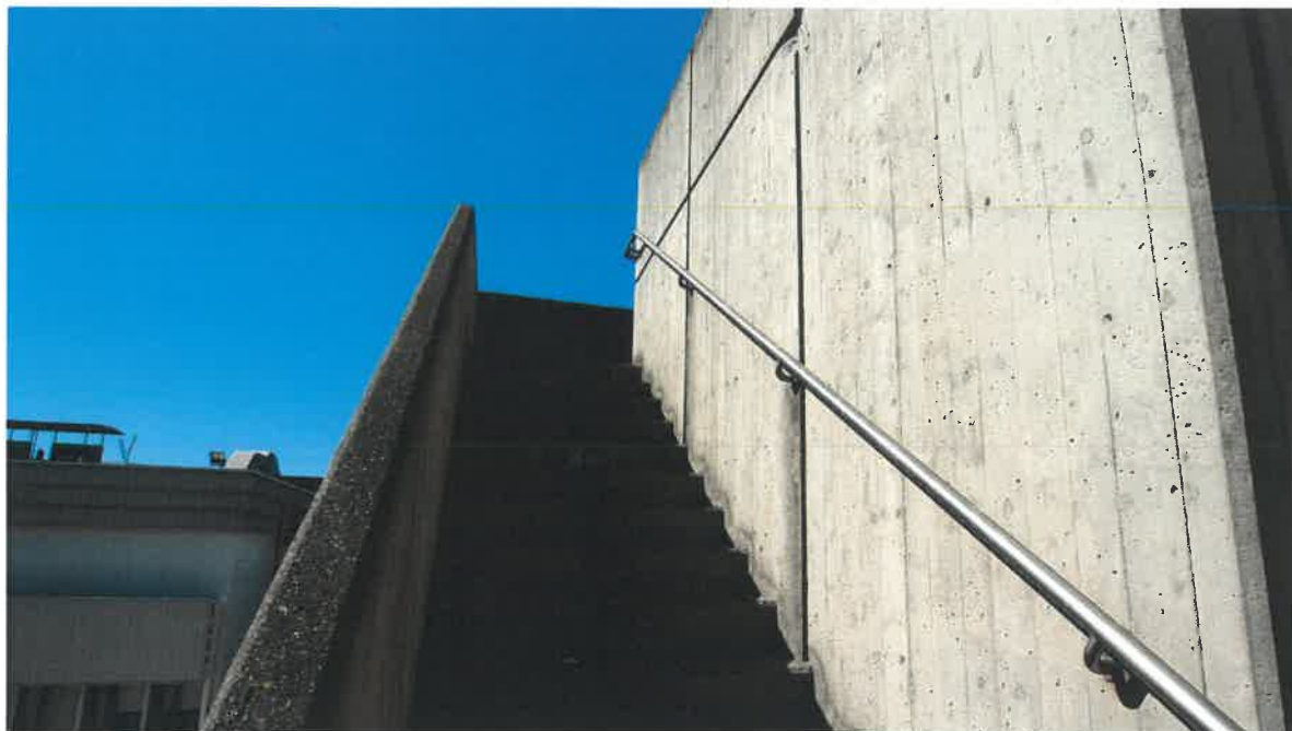
E55 - lato est. Scala di emergenza in c.a. deteriorato
