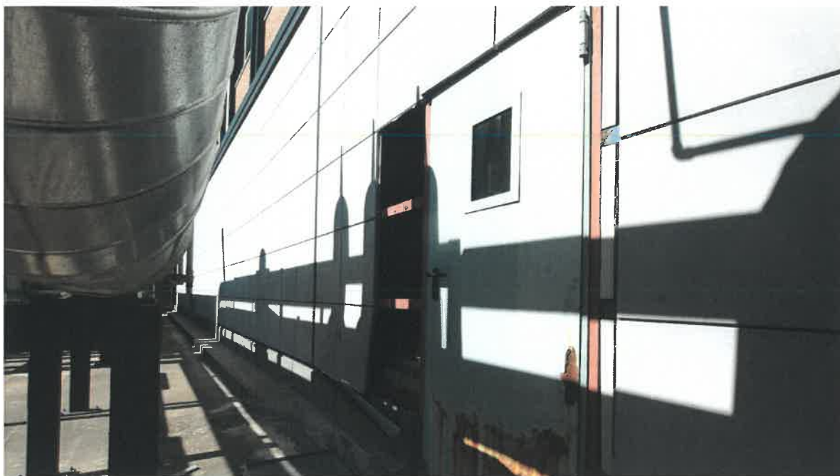
E55 - Pannelli fonoassorbenti a ridosso del prospetto Est. La porta non è più utilizzabile
