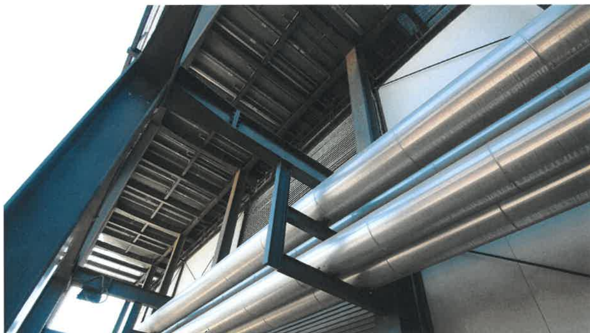
E55 - lato Nord - Distribuzioni tubazioni coibentate. Evidente l'ossidazione delle strutture in acciaio
