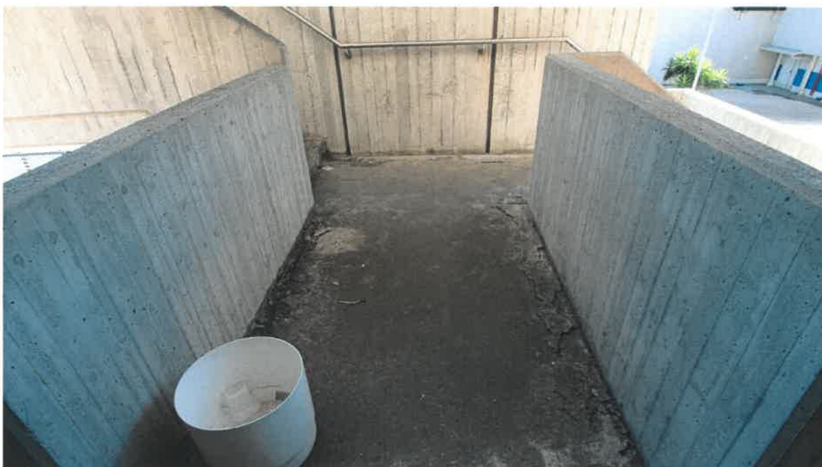
E55 - lato est. Scala di emergenza in c.a. - Particolare delle condizioni di degrado dei pianerottoli
