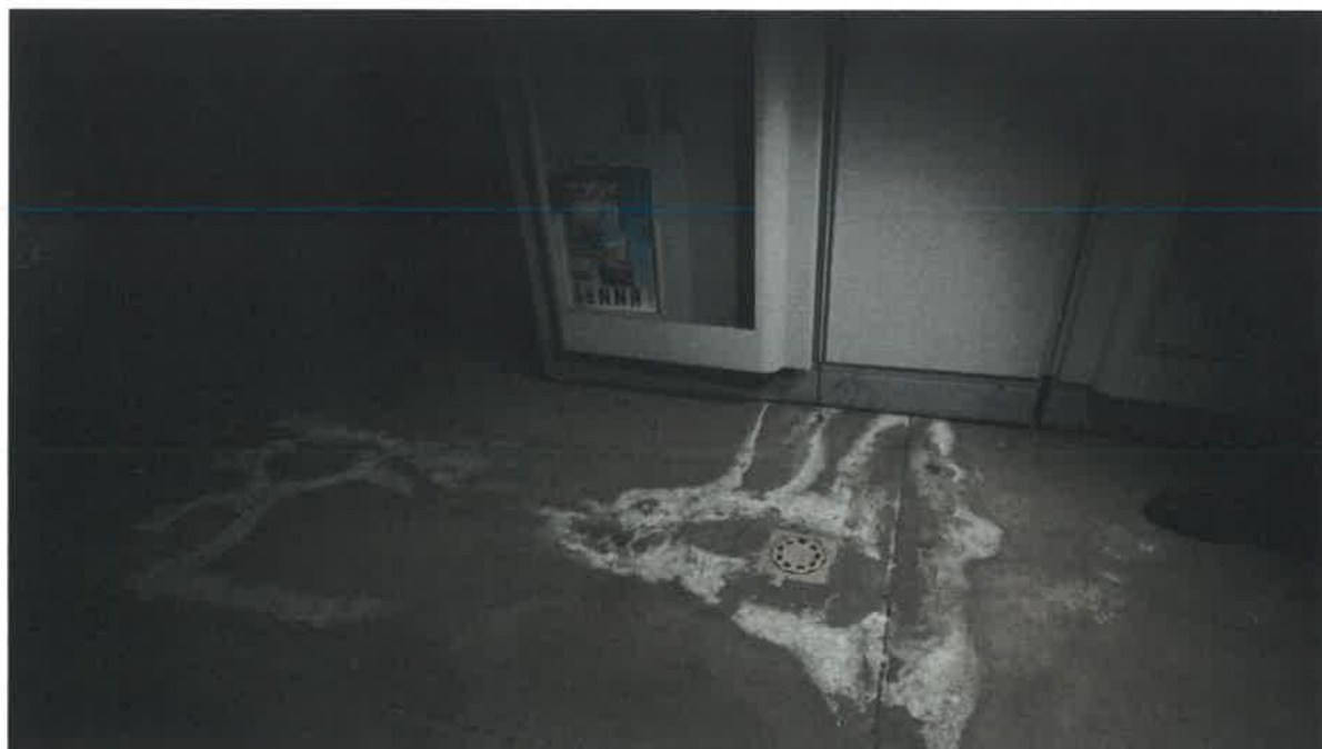
E55 - Blocco utilities. Evidenti le infiltrazioni meteoriche
