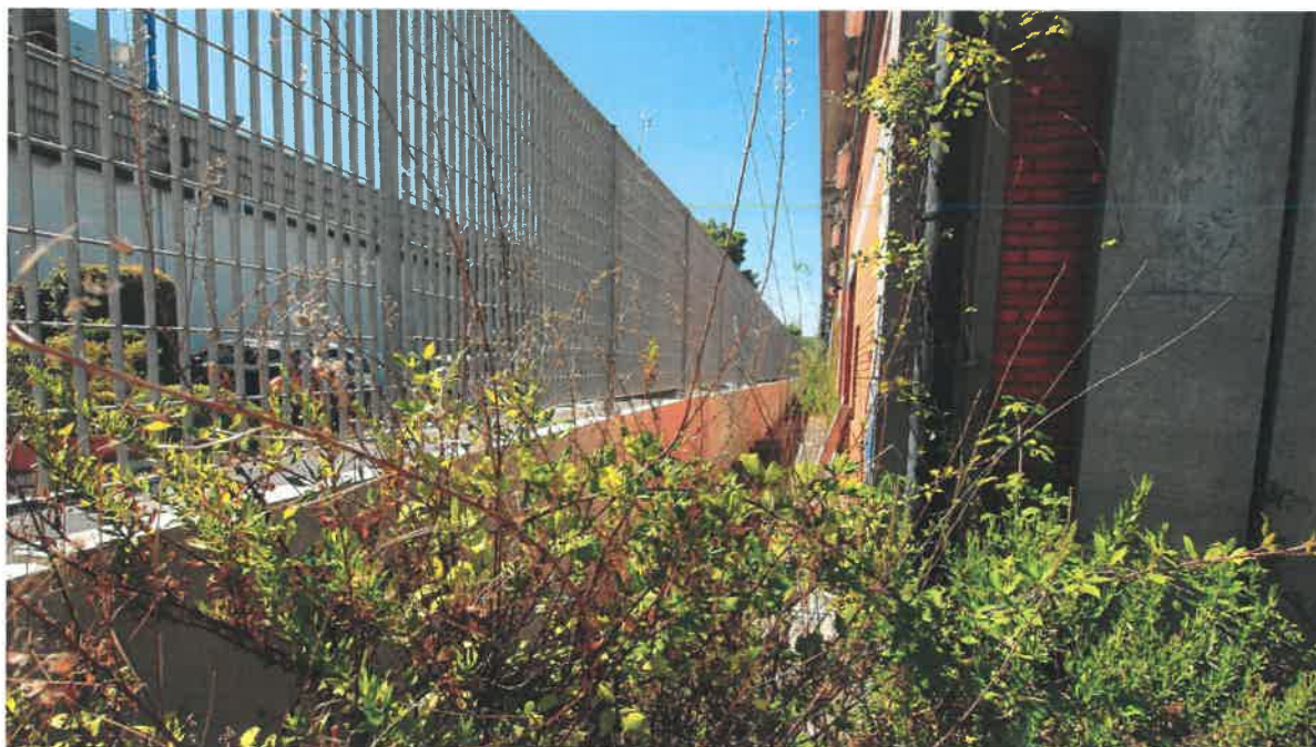
E55 -Collegamento edifici 55 e 33 lato est ormai impraticabile
