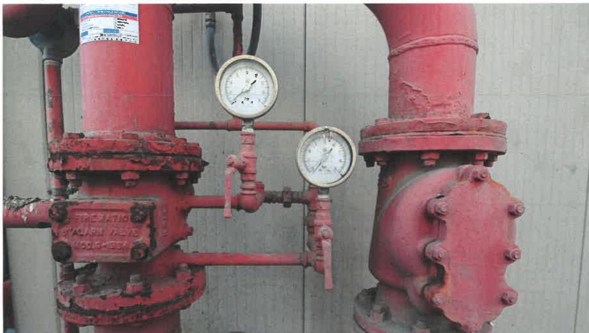
E55 - lato ovest. Valvola impianto sprinkler in cattive condizioni di manutenzione
