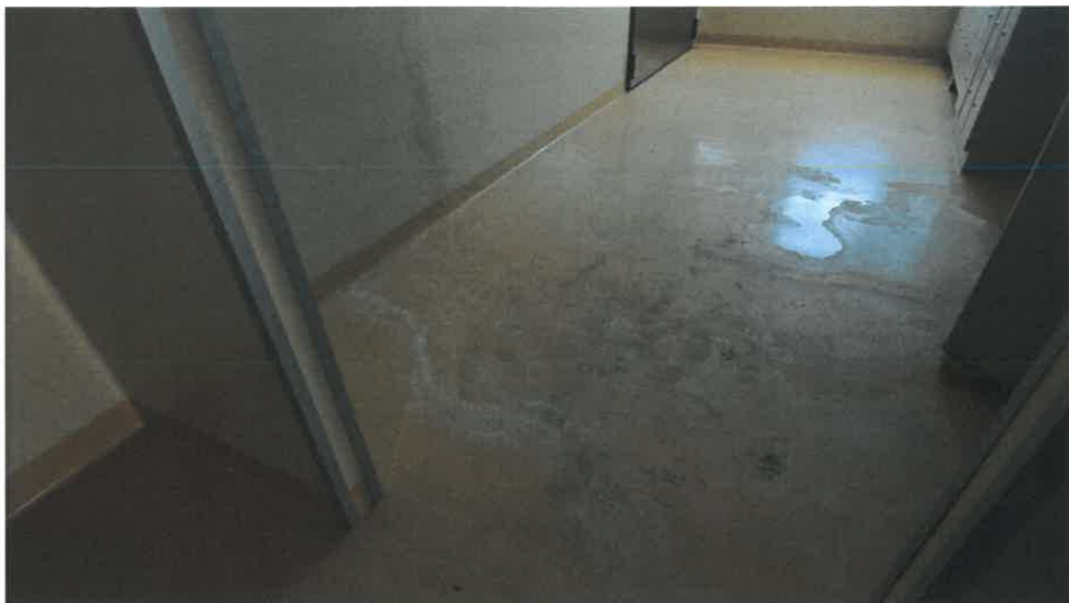
E55 - Interno corridoio di distribuzione piano 2 - Evidenti le infiltrazioni
