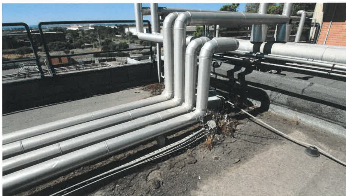
E55 - Lastrico solare: Tubazioni coibentate di distribuzione fluidi. Si notano le condizioni dell'impermeabilizzazione
