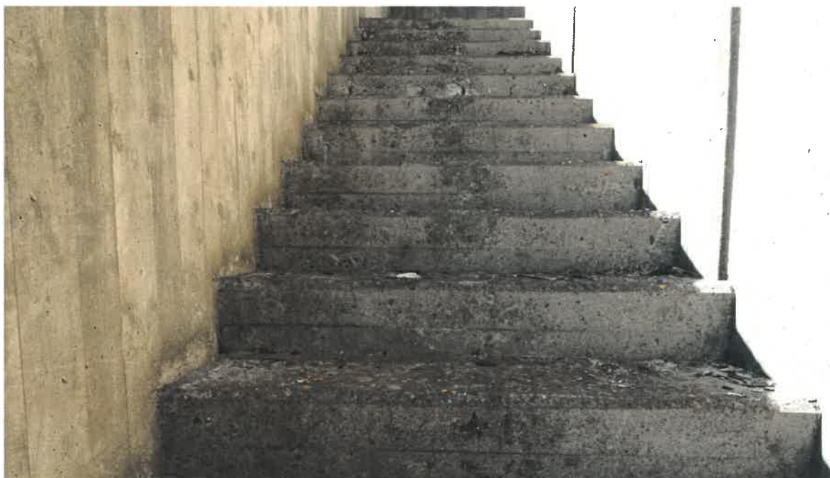
E55 - lato est. Scala di emergenza in c.a. - Particolare delle condizioni di degrado dei gradini
