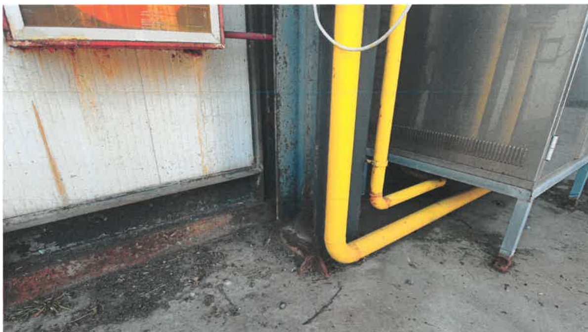
E55 - Sottostazione distribuzione gas metano. Evidente il deterioramento per ossidazione di impianti e supporti
