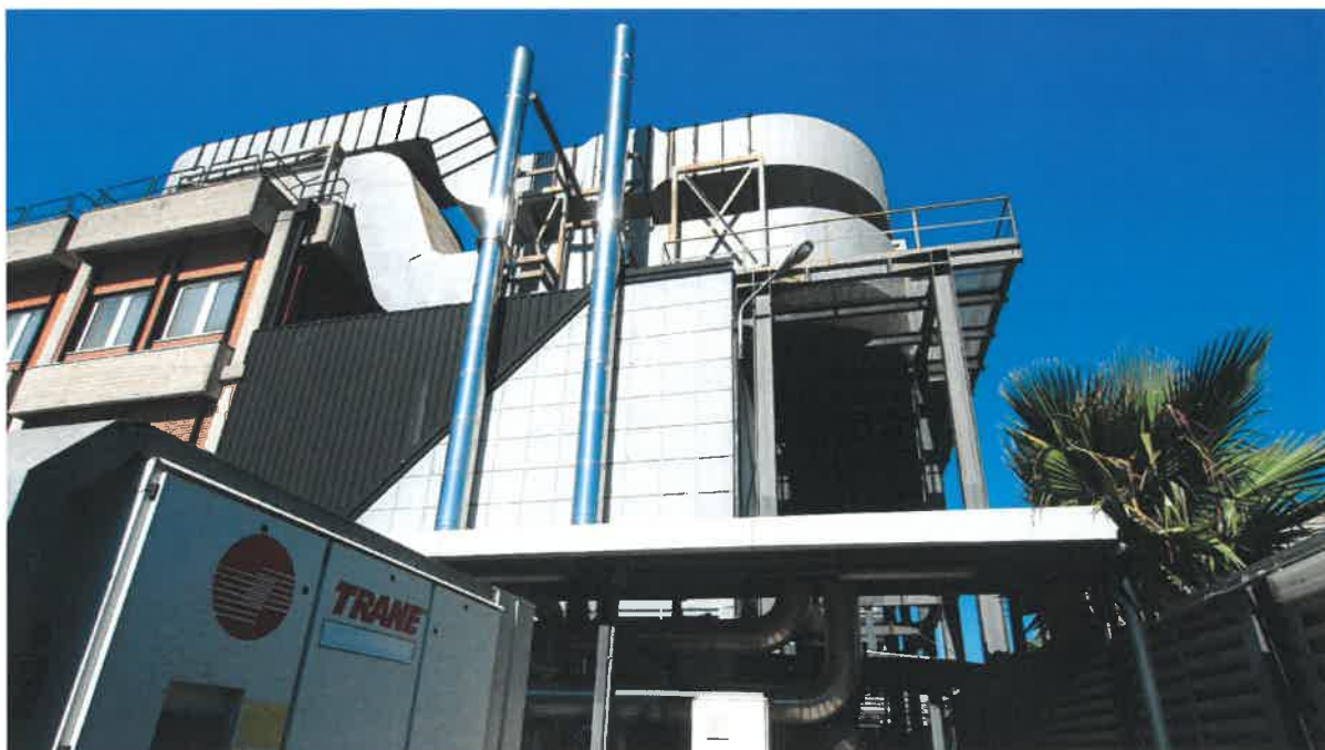
E55 - Lato est: Zona posizionamento chiller frigoriferi e schermi a confine con lo stabilimento Pfizer
