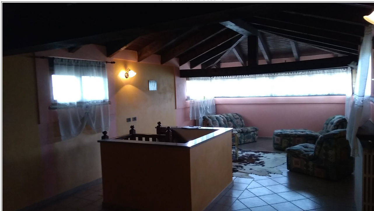
Interno sottotetto abusivo
