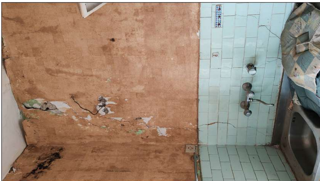
foto 23 - vista della cucina al piano 2° con le lesioni sulle pareti.
