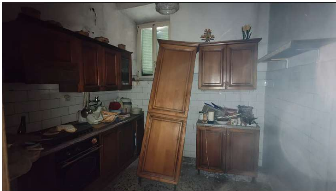
foto 9 - vista della cucina 1.
