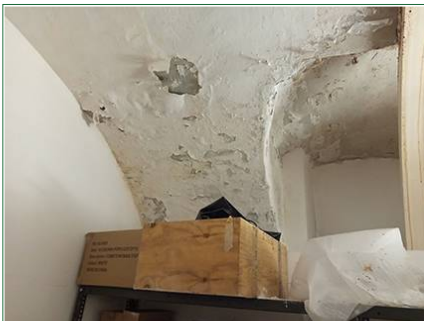
Danni da infiltrazione di acque meteoriche nel locale cantinato
